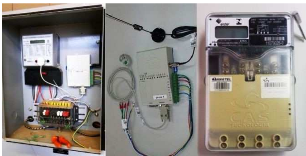
Figura 16: Conjunto de Telemedição Gateway/Remota e Medidor Inteligente
