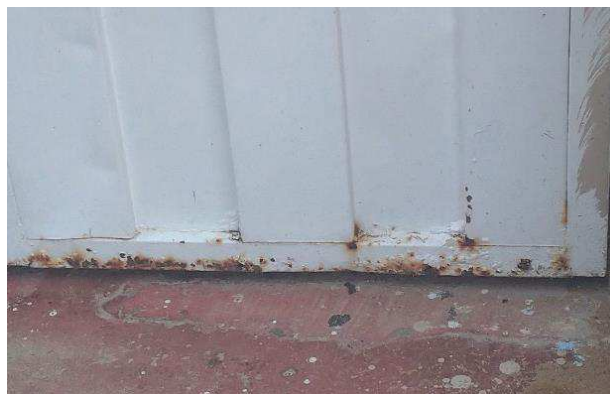
Figura 28 – Material da porta corroído e enferrujado.
