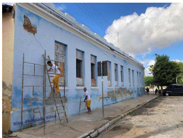
Figura 17 – Reparos no revestimento da fachada lateral.
