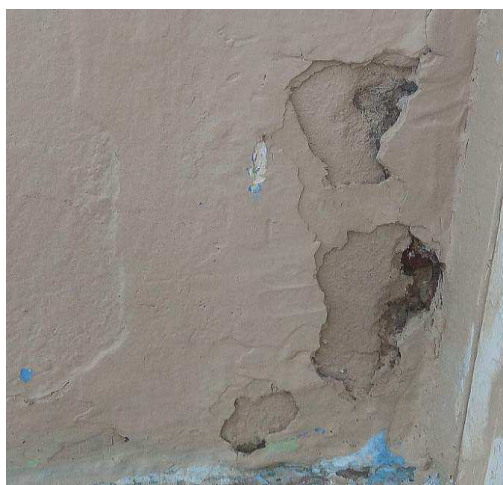
Figura 30 – Destacamento do revestimento na fachada frontal.
