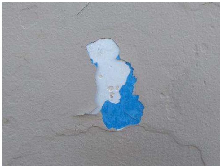
Figura 29 – Desprendimento da pintura na fachada frontal.
