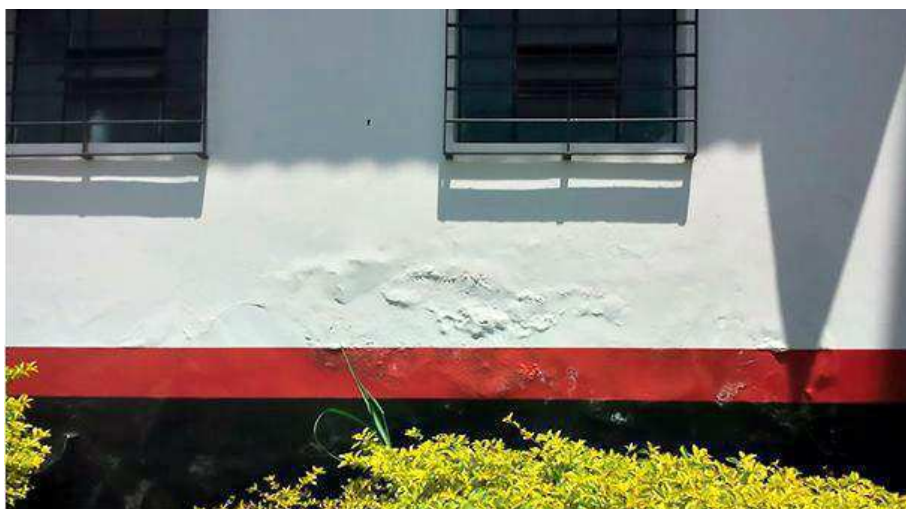
Figura 3 – Descolamento por empolamento.
