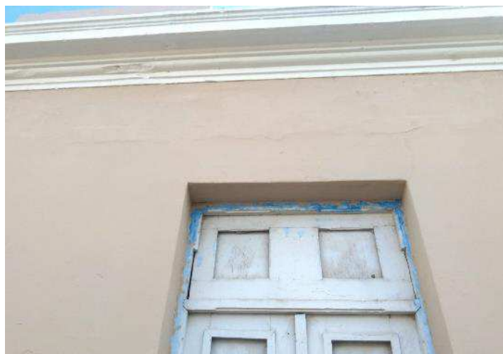
Figura 25 – Fissura horizontal na fachada frontal.
