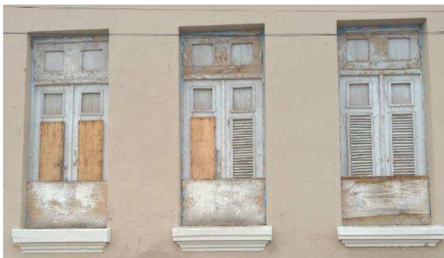
Figura 27 – Janelas deterioradas na fachada frontal.
