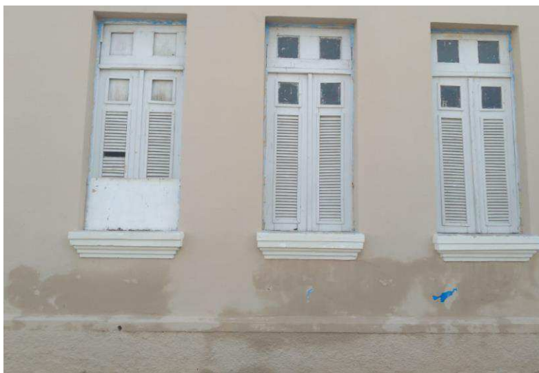
Figura 21 – Manchas devido à umidade presente na fachada principal.
