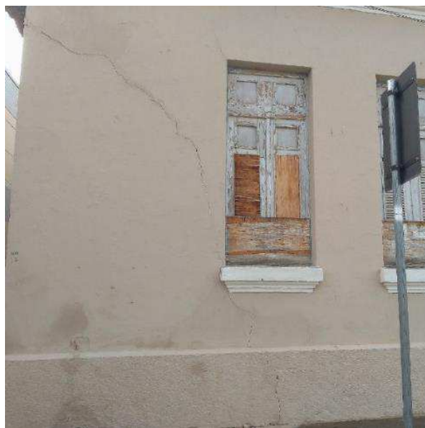
Figura 26 – Rachadura detectada na fachada lateral.
