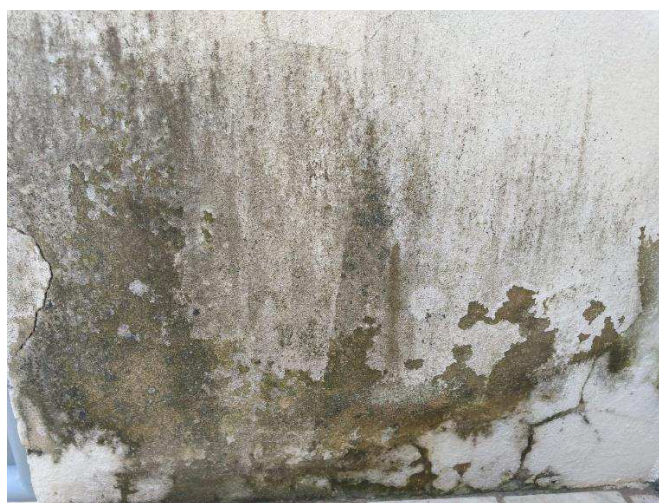
Figura 2 – Bolor na superfície de alvenaria externa em uma residência.
