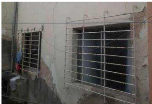
Figura 4 – Desagregação da pintura.
