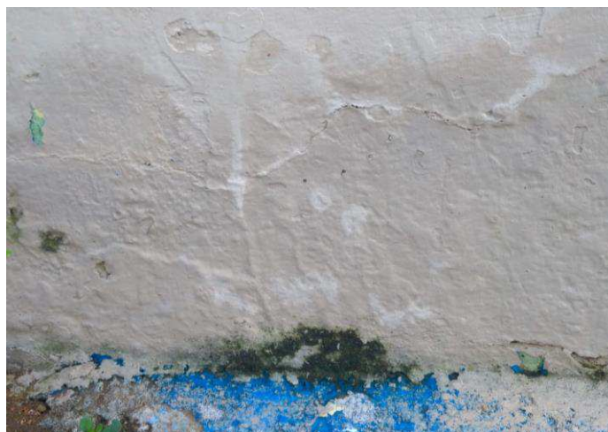
Figura 22 – Bolor identificado na fachada frontal.
