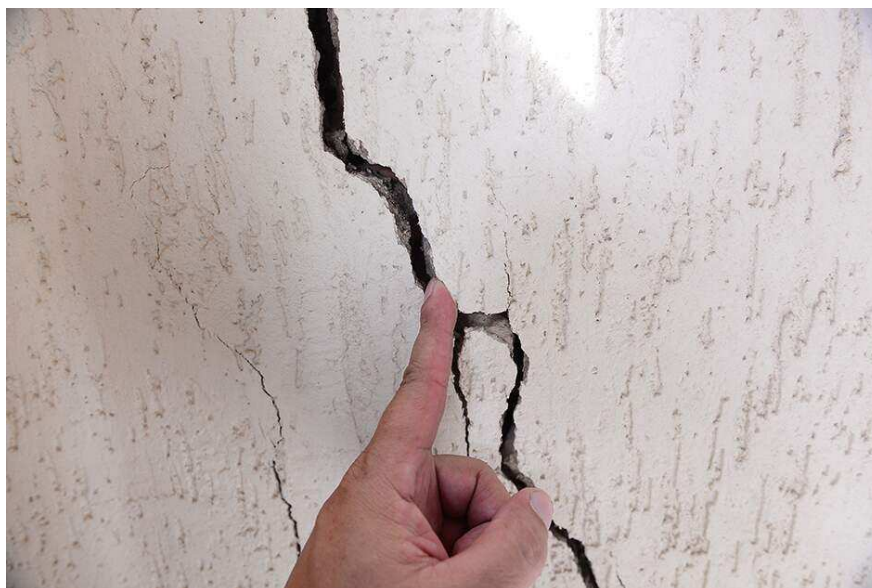
Figura 7 – Rachadura em alvenaria.
