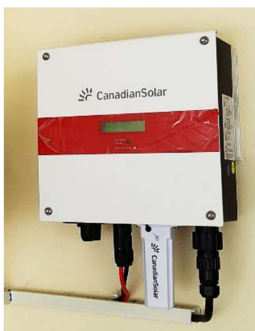
Figura 12 - Inversor monofásico de 1,5 kW instalado na cidade de Campina Grande.
