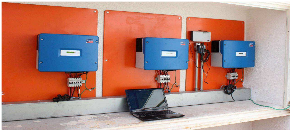
Figura 5: Inversores de corrente e equipamentos de proteção instalados em sistema.
