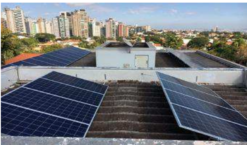
Figura 15: Sistema fotovoltaico fixado em telhado de fibrocimento
