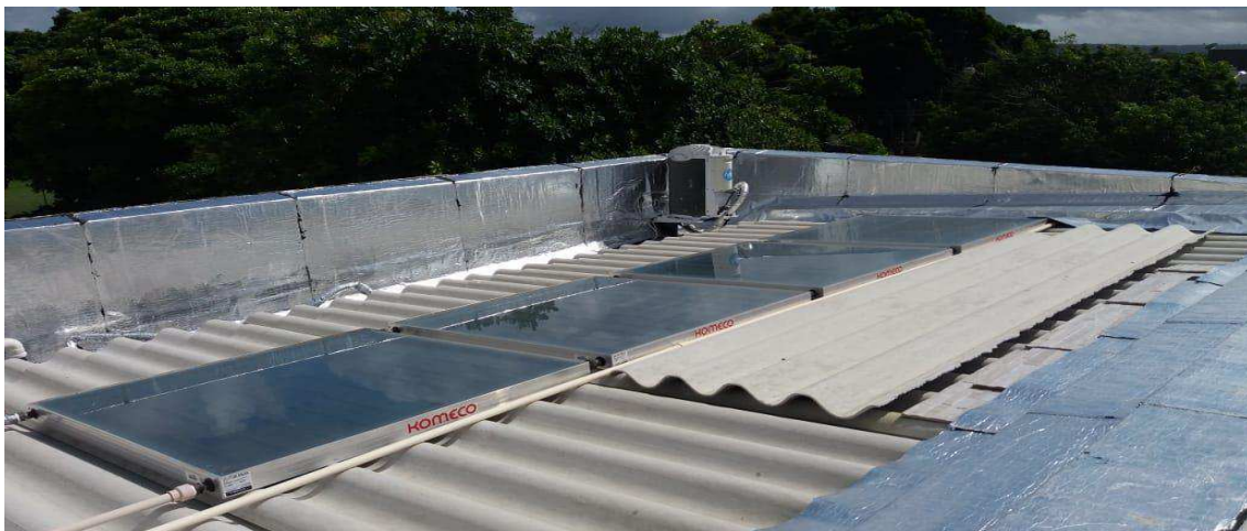
Figura 2: Painéis solares térmicos instalados.
