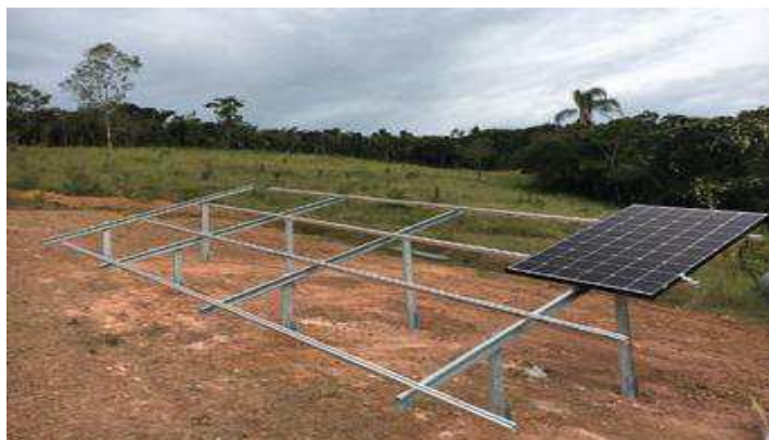
Figura 17: Estrutura de fixação de sistemas fotovoltaicos direta no solo.
