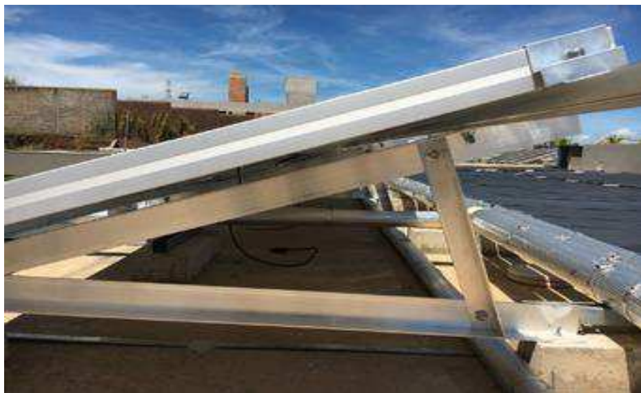
Figura 16: Sistema fotovoltaico fixado em laje.
