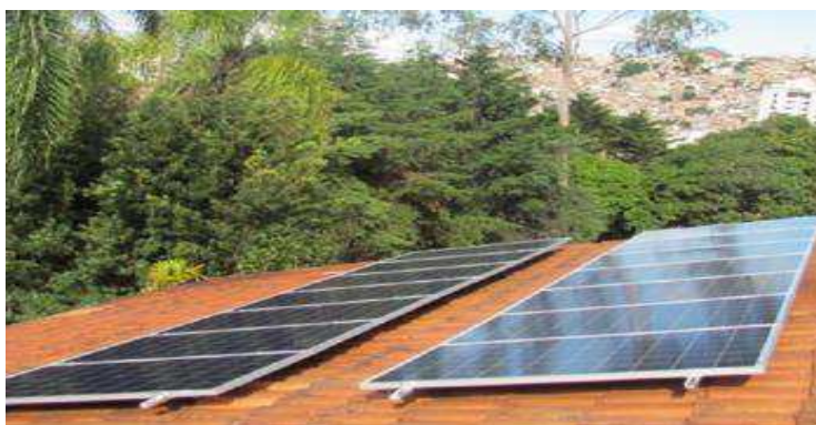
Figura 13: Sistema fotovoltaico instalado em telhas cerâmicas.
