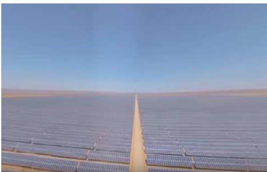
Figura 4.2 – Vista do parque solar Nova Olinda.
