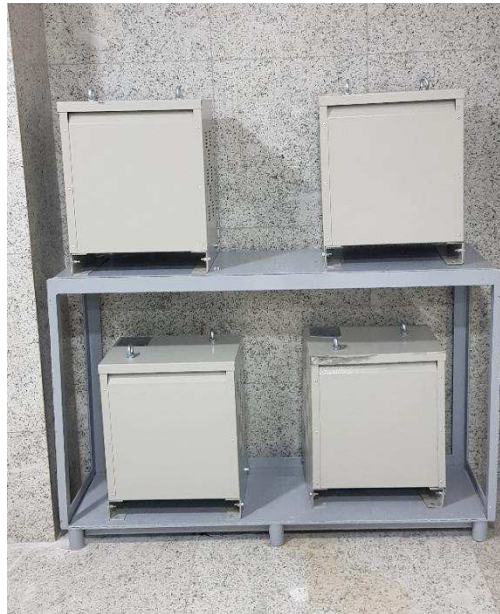
Figura 18 – Transformadores do IT Médico 5º andar RHC.
