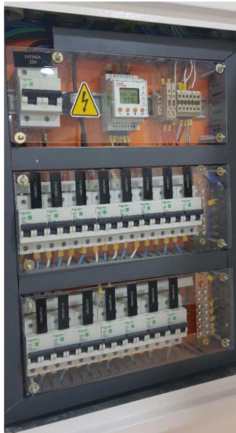
Figura 19 – Quadro elétrico de alimentação de 5 apartamentos.
