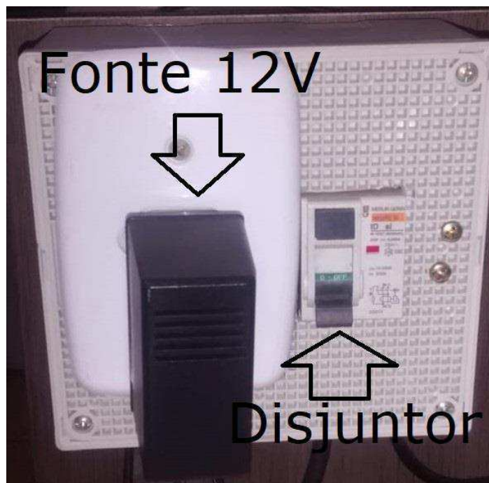
Figura 16 - Fonte e Disjuntor
