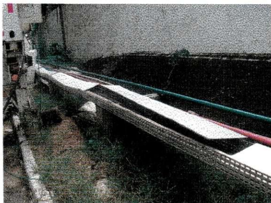
Figura 8. Fotografia da eletrocalha.
