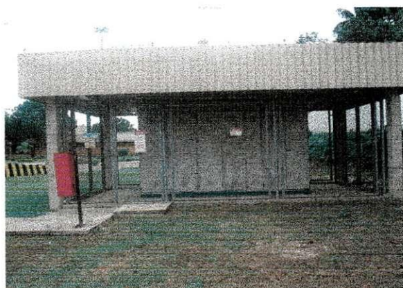
Figura 9. Fotografia da Subestação de Recebimento de 13,8kV.
