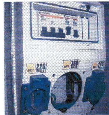
Figura 7. Fotografia das tomadas.
