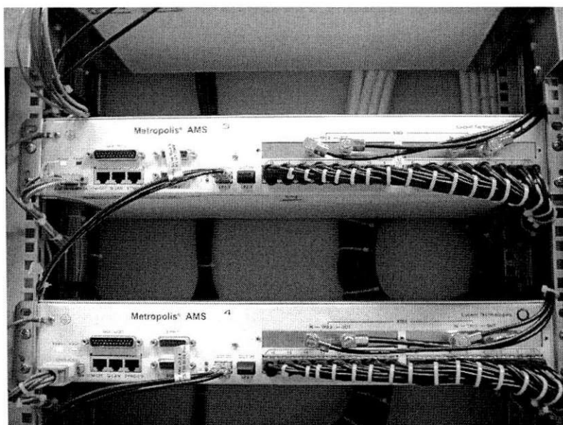
Figura 25 – Elementos de Rede Instalados pela SAVENGE em Recife, PE.
