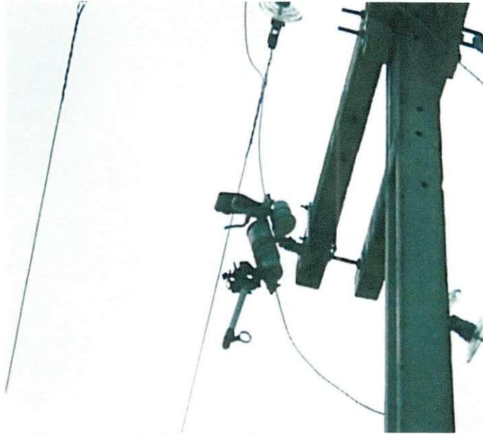
Figura 30: Isolador da chave fusível quebrado.
