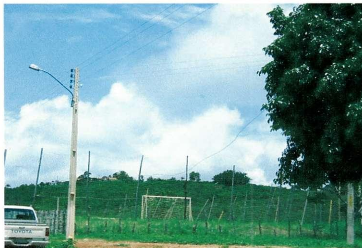
Figura 36: Cabo quebrado de BT.
