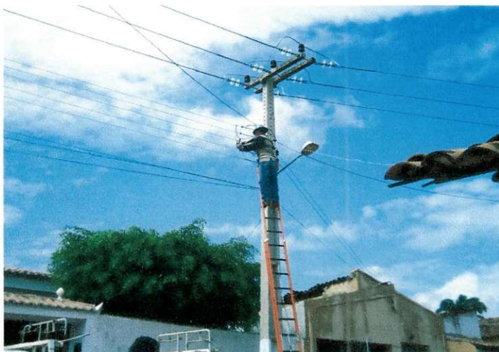
Figura 37: Defeito em conexão.
