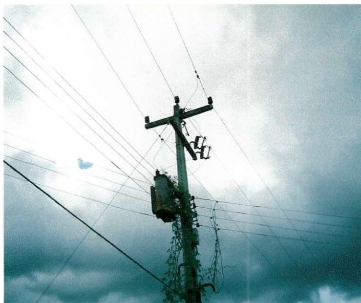
Figura 32: Elo atuado em chave de trafo, causa descarga atmosférica.
