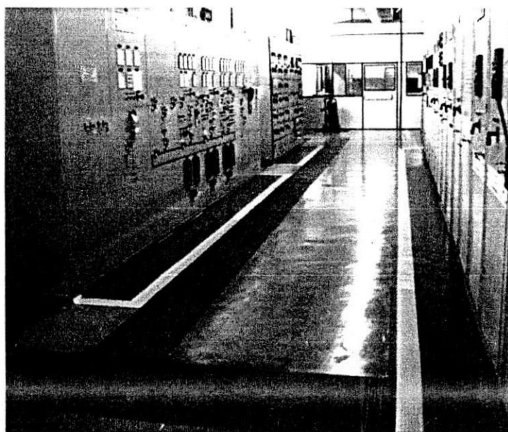
Figura 3.3.2.1. : Sala de controle – Área interna da subestação principal
