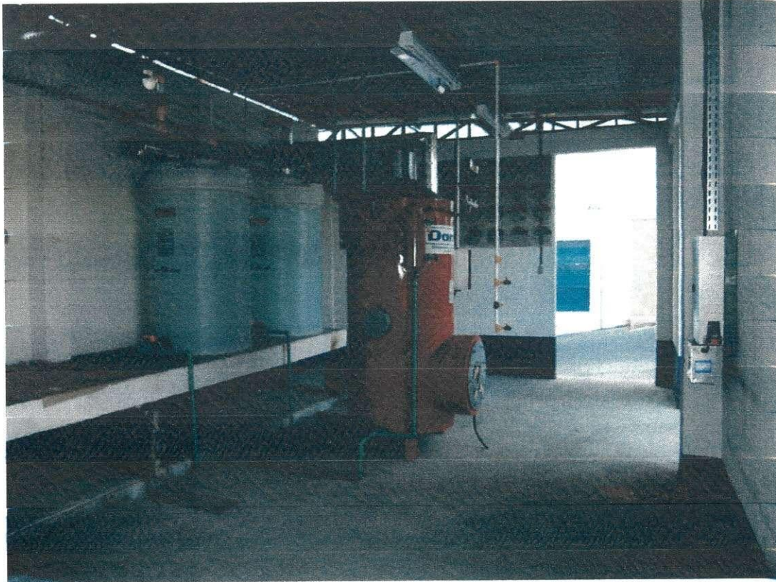
Figura 8: Foto da casa de caldeiras
