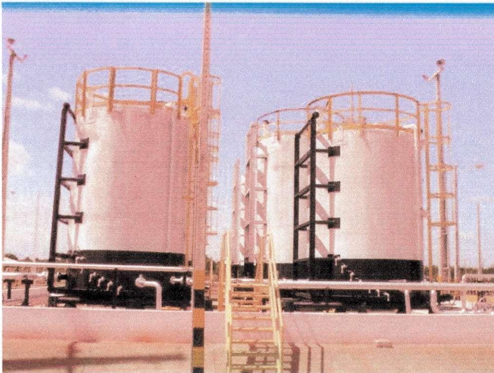
Figura 3 – Tanques de armazenamento de petróleo – foto da estação de brejinho.
