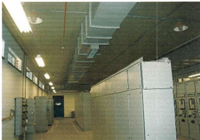
Figura 24. Sala de painéis de subestação
