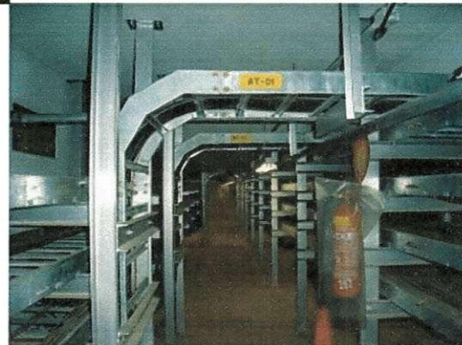
Figura 21. Exemplos de instalações com bandejas realizadas em subestações
