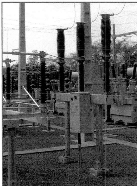
Figura 24: Disjuntor da SE Porto das Pedras.
