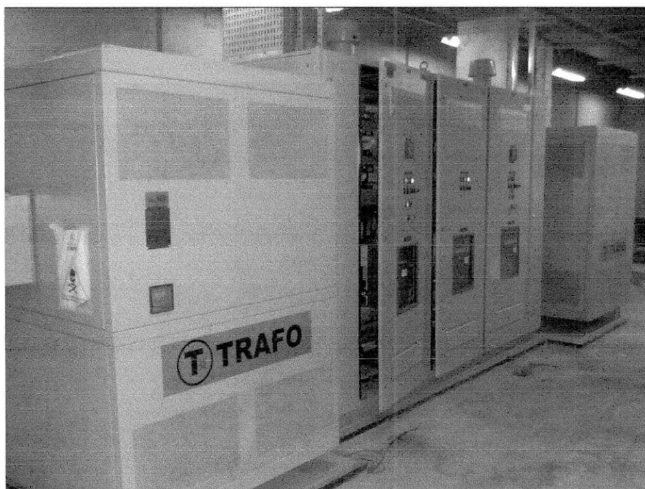
Figura 6: CCM Geradores e Transformadores a Seco.
