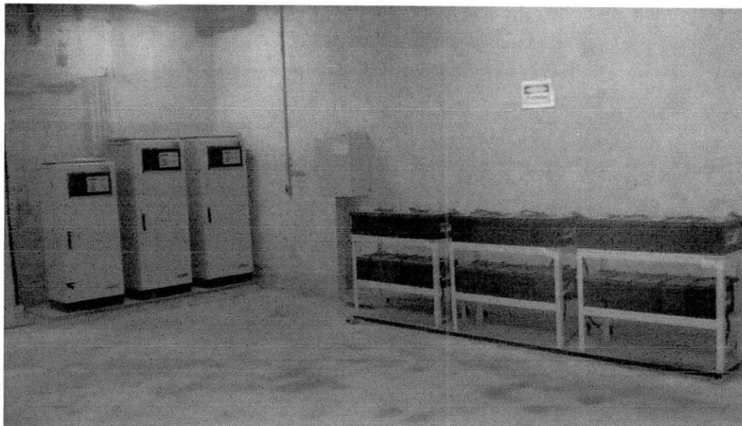
Figura 11: Retificadores/Carregadores e bancos de baterias
