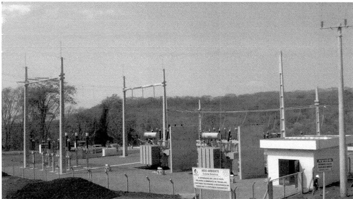
Figura 22: Subestação elevadora da PCH Porto das Pedras.
