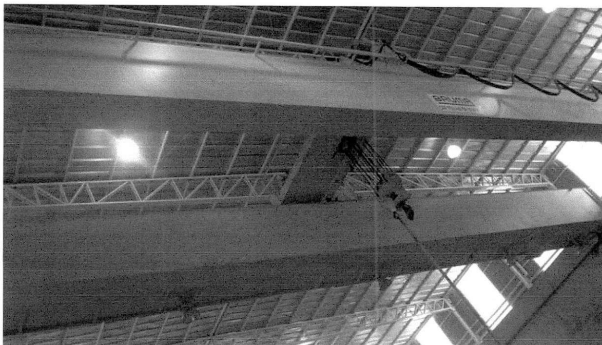
Figura 16: Ponte Rolante da PCH Porto das Pedras.
