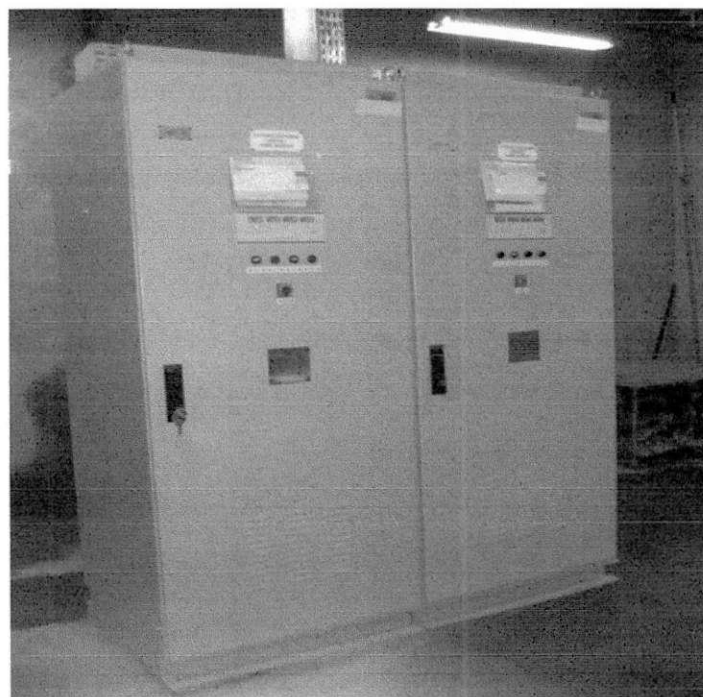
Figura 10: Inversores de frequência.
