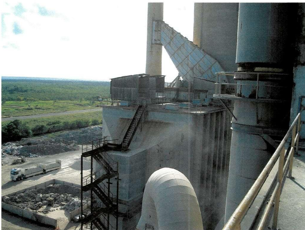
Figura A.5: CIPASA – Eletrofiltro.
