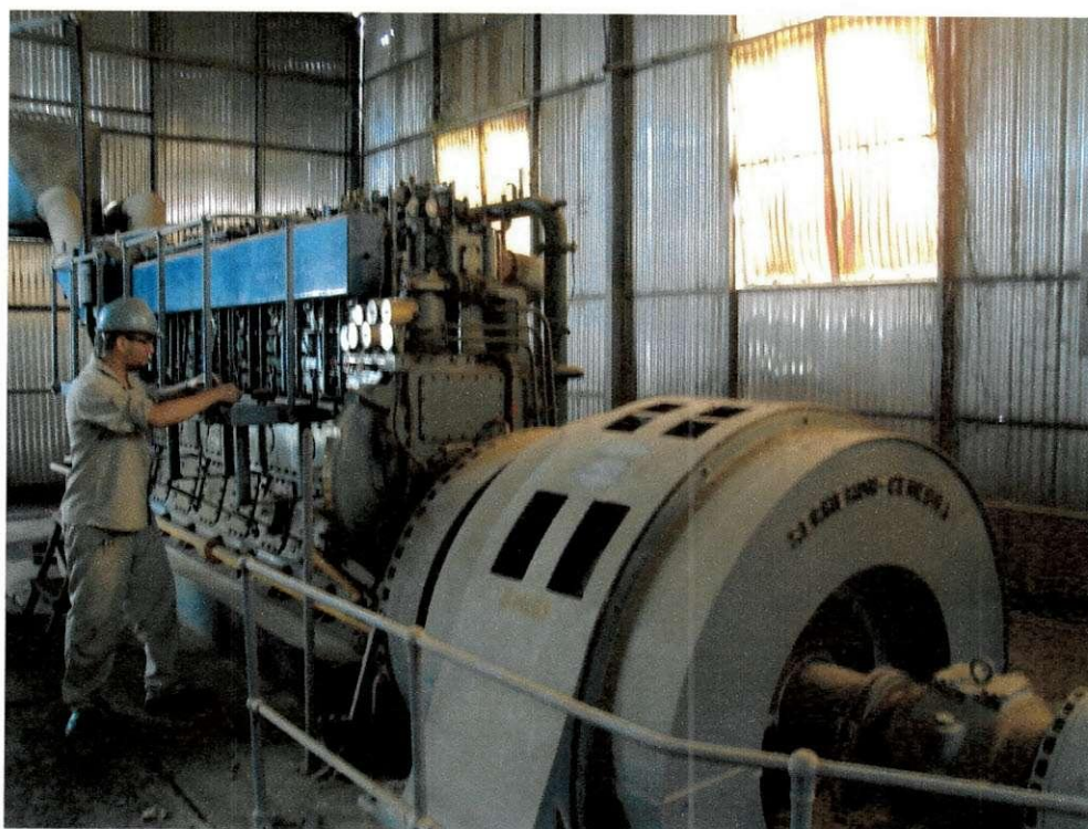
Figura 24: Companhia de Cimento Poty Paulista – Gerador síncrono de 1000 kVA abandonado.
