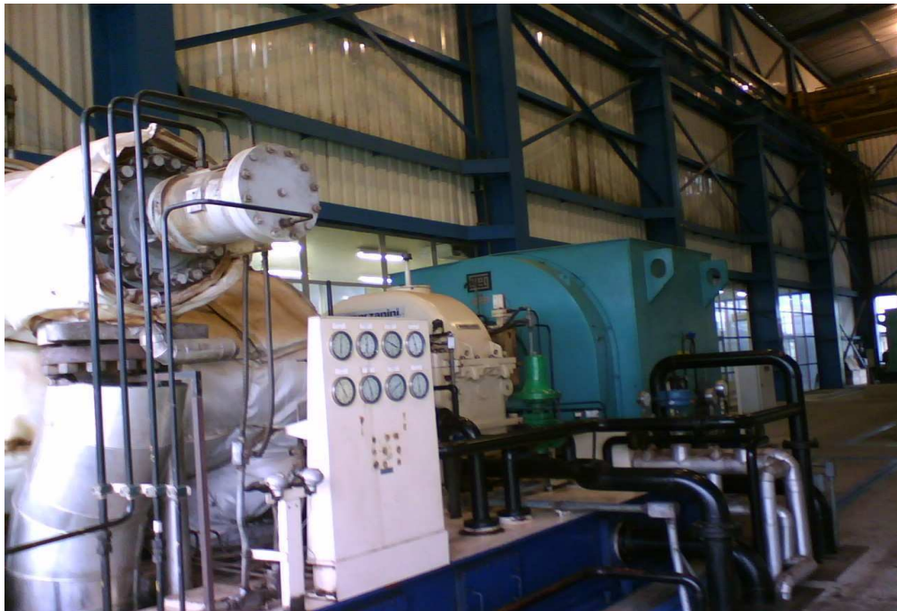
Figura 05: Turbogenerador Weg da Termoelétrica Itaipu.
