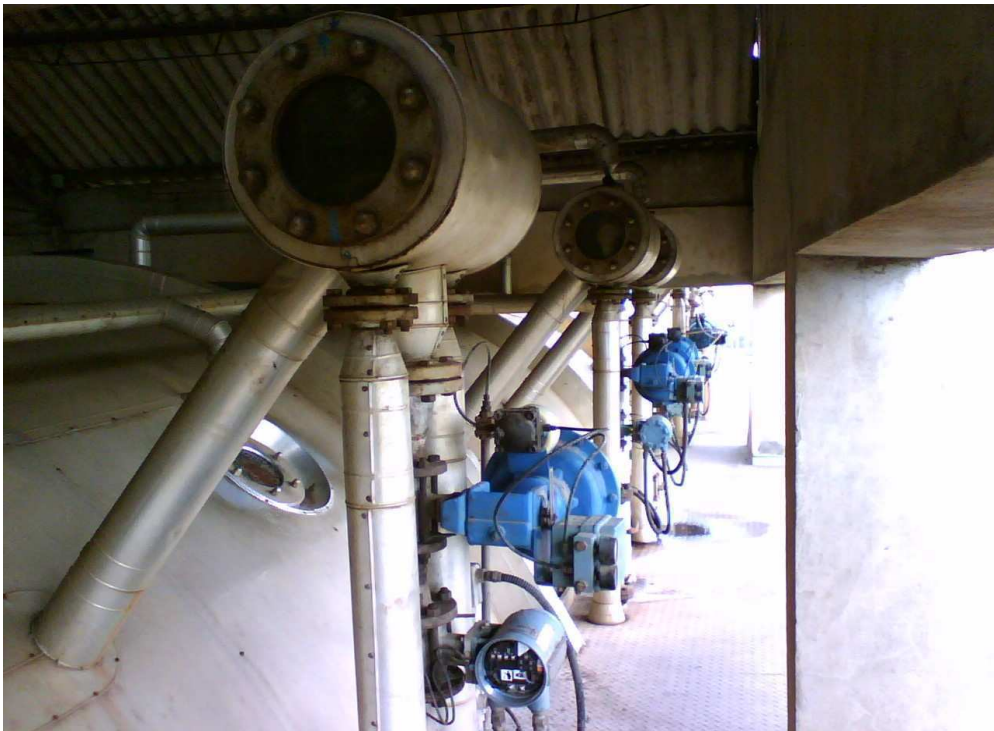
Figura 13: Válvulas, sensores e posicionadores do vácuo contínuo.
