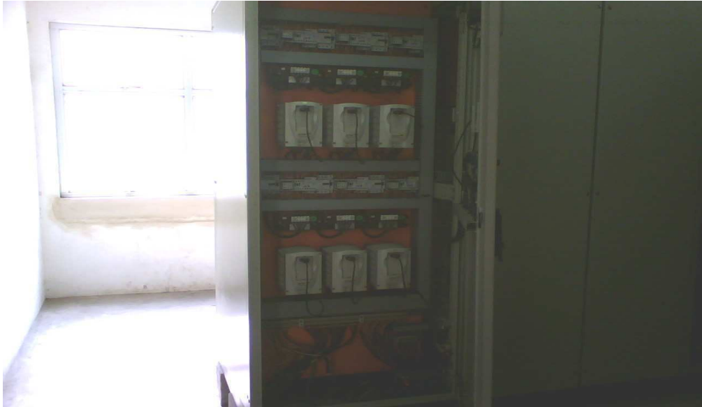
Figura 11: Quadro de controle dos dosadores de bagaço da caldeira Cogemax.
