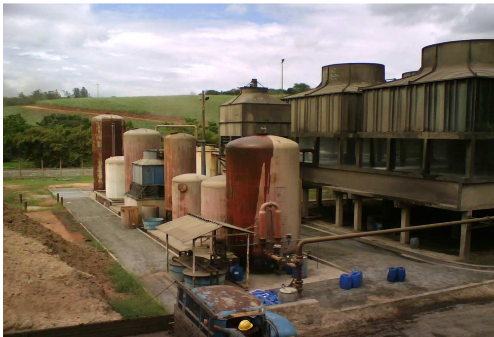
Figura 08: ETA de 100 m 3
