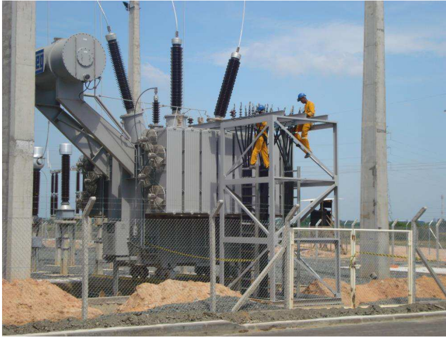
Figura 2.2 – Transformador Elevador 80/95 MVA
