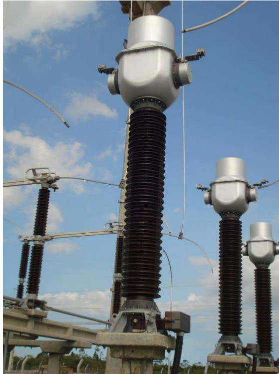
Figura 2.4 – Transformadores de Corrente
