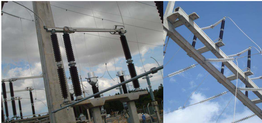
Figura 2.6 – Chaves seccionadoras terrestres e de by pass
