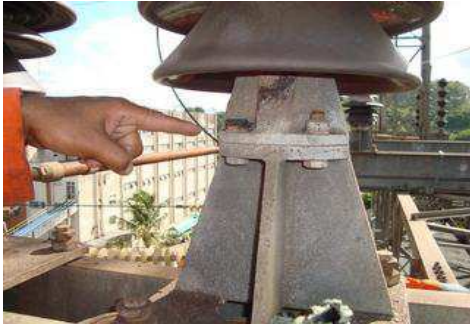
Figura 53 - Fotografia do processo corrosivo do parafuso da base da cadeia de isoladores tipo pedestal.
