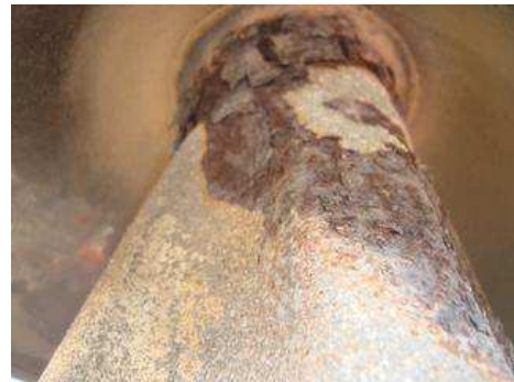
Figura 56 - Fotografia do processo corrosivo da cadeira de isolador do tipo pedestal da chave seccionadora.
