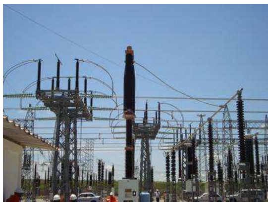
Figura 60 - Fotografia da SE PAIII da chave 34B1-3
