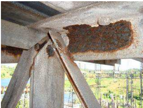
Figura 55 - Fotografia do processo corrosivo da estrutura da chave seccionadora.
