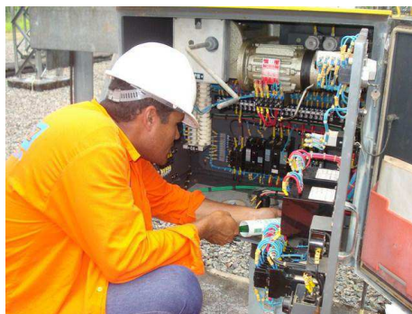
Figura 57 – Fotografia da Realização do Ensaio de Tensão aplicada nos Circuitos Auxiliares
