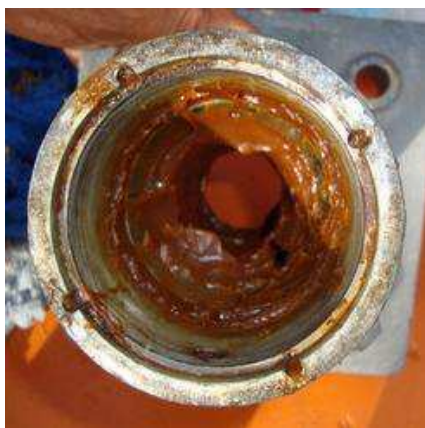
Figura 50 - Fotografia da parte interna do mancal antes da limpeza.
