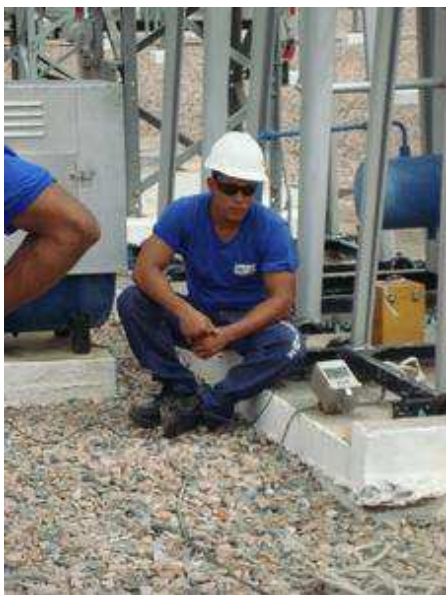
Figura 41 - Fotografia do eletricitista monitorando a corrente de fuga.
