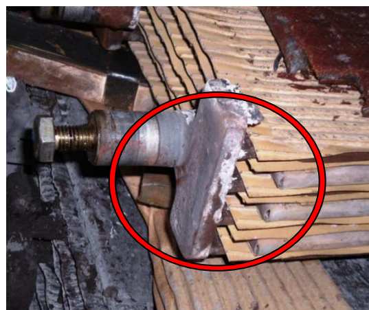
Figura 35-Solda do pólo negativo com grande quantidade de sulfato de chumbo
