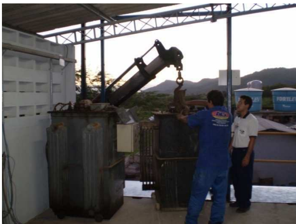
Figura 30-Retirada de retificadores com defeito
