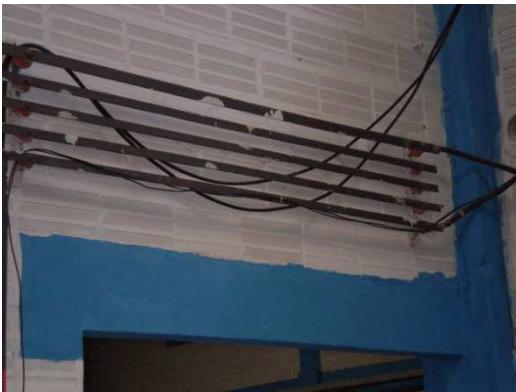
Figura 32-Barramentos expostos ao meio ambiente
