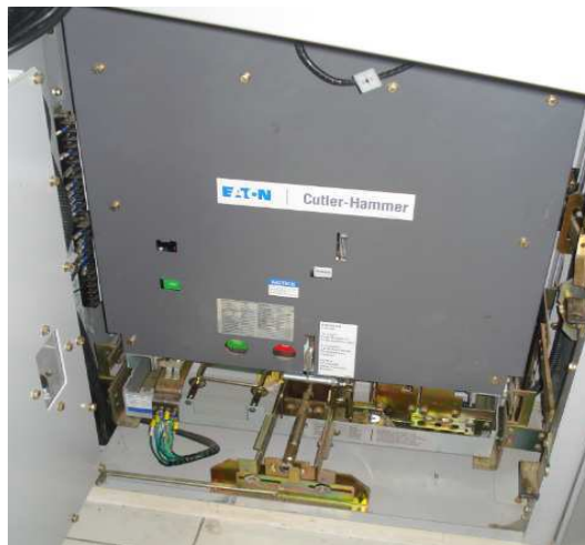
Figura 38 – Disjuntor instalado no Painel 13,8 kV.
