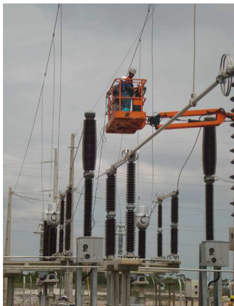
Figura 67 – Comissionamento da Subestação 230 kV.
