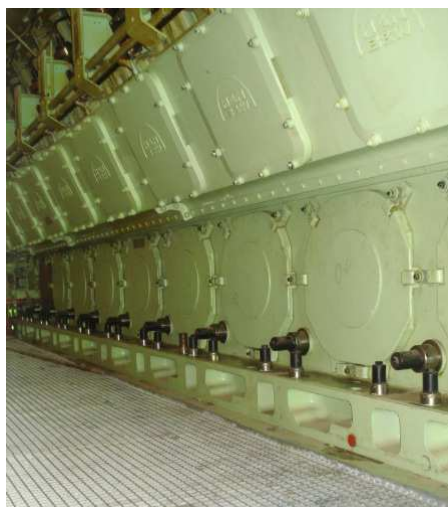
Figura 32 – Vista lateral do motor MAN Diesel.
