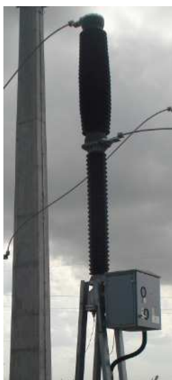
Figura 60 – Disjuntor a gás SF 6 da subestação 230 kV.
