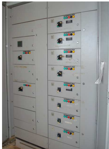
Figura 17 – Vista frontal do Painel CCM UOS.
