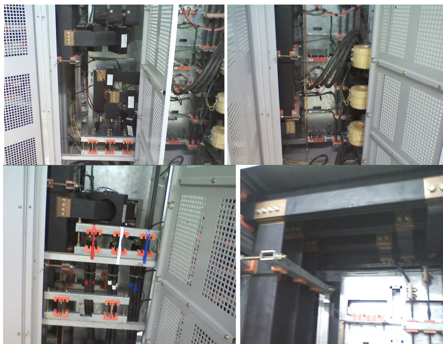
Figura 12 – Parte interna do painel CDC.
