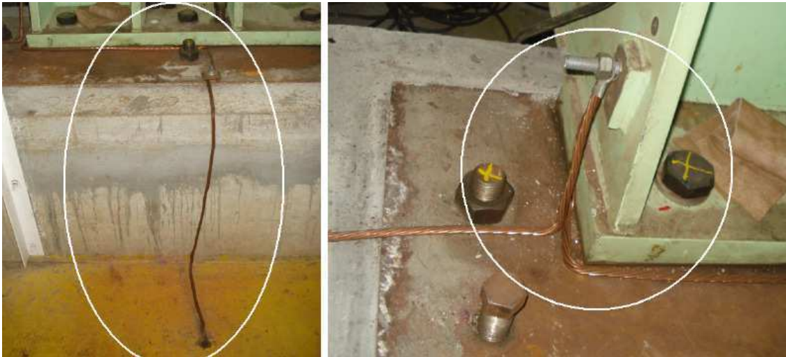
Figura 45 – Aterramento efetuado no gerador 7.
