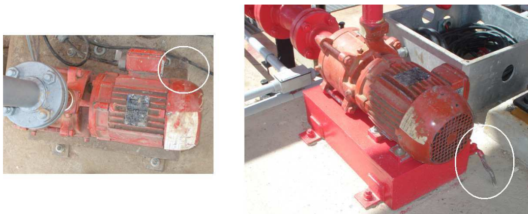
Figura 28 – Correção do aterramento dos motores.
