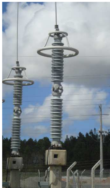
Figura 66 – Pára-raios da subestação 230 kV.
