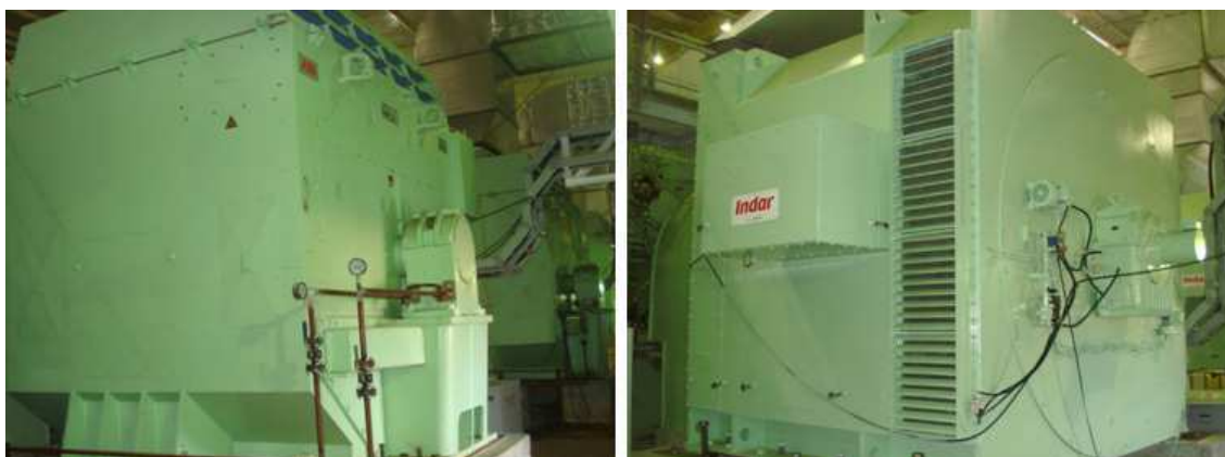
Figura 34 – Geradores ABB e INDAR.
