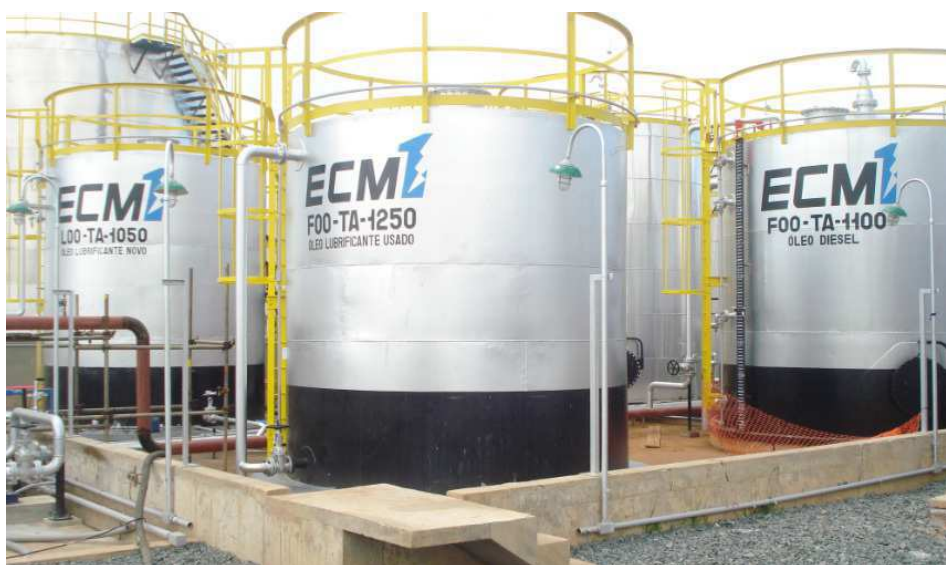
Figura 6 - Tanques de processos.
