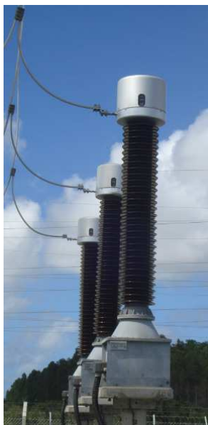
Figura 65 – Transformador de Potencial da subestação 230 kV.
