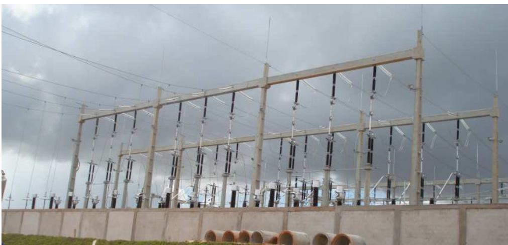
Figura 5 – Entradas de Linha da Subestação Pólo.
