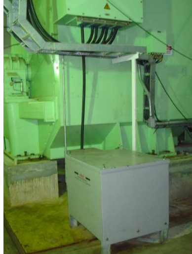
Figura 35 – Resistência de Aterramento.
