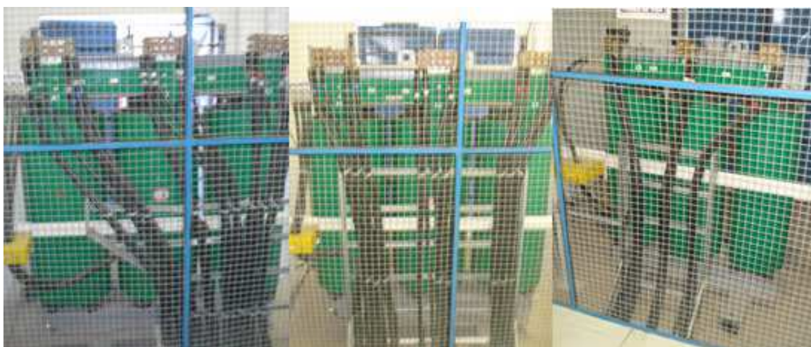
Figura 8 – Transformadores Auxiliares – TSA's.
