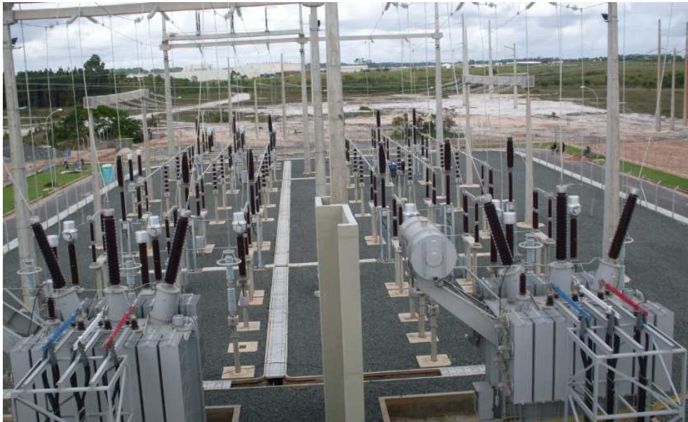
Figura 4 – Subestação 230 kV da Usina Termelétrica Muricy I.
