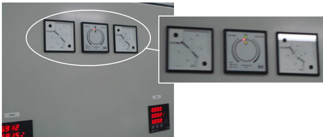
Figura 58 – Sincronização dos geradores com a rede básica.
