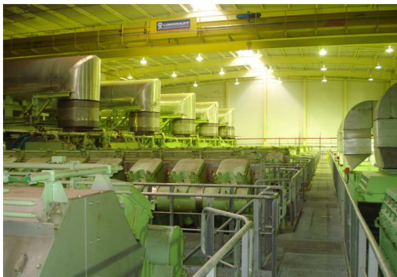
Figura 2 – Vista superior dos conjuntos motor-gerador.
