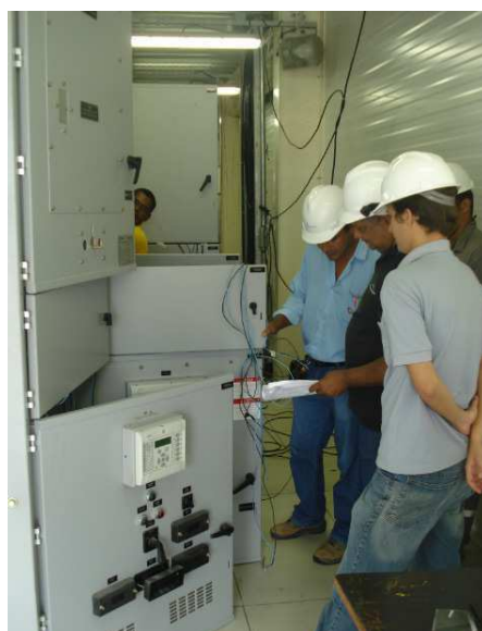
Figura 54 – Testes dos circuitos de comando do Painel EATON 13,8 kV.
