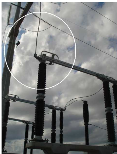
Figura 75 – Chaves Seccionadoras térreas do TIE antes da correção.
