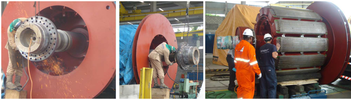
Figura 47 – Manutenção nos rotores.
