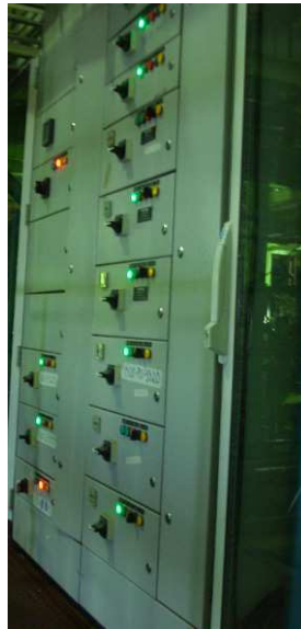
Figura 15 – Vista frontal do Painel CCM CAS.
