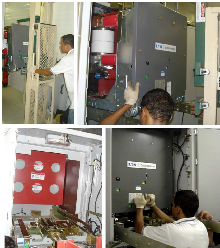
Figura 53 – Teste dos intertravamentos dos disjuntores do Painel EATON.
