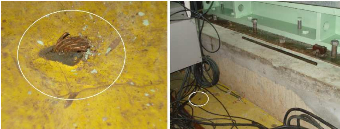
Figura 44 – Aterramento não efetuado do gerador 7.
