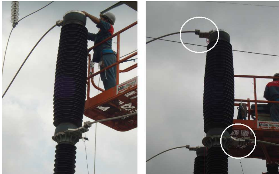
Figura 71 – Realização do teste de resistência entre contatos.
