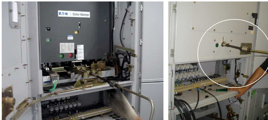
Figura 40 – Chave rotativa operando o disjuntor.
