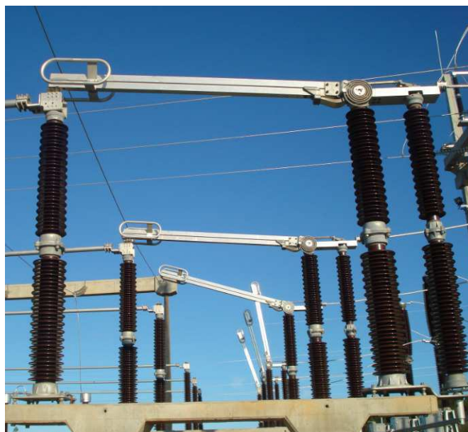
Figura 74 – Abertura desregular das chaves seccionadoras.
