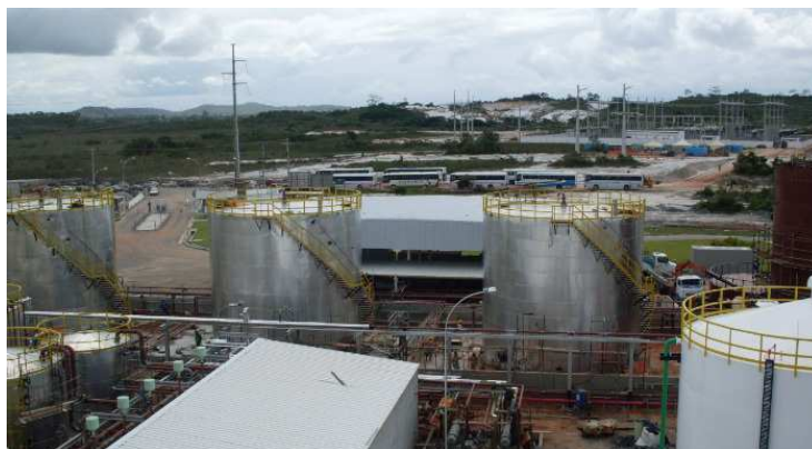
Figura 7 – Tanques de armazenamento de HFO, armazenamento de água e tanques de processos.
