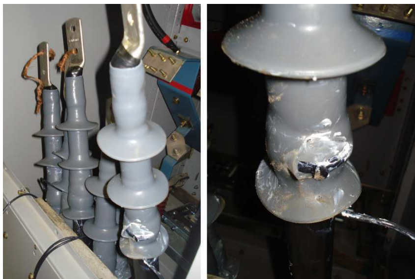
Figura 52 – Muflas danificadas do cabo 13,8 kV reprovado no teste de isolamento.
