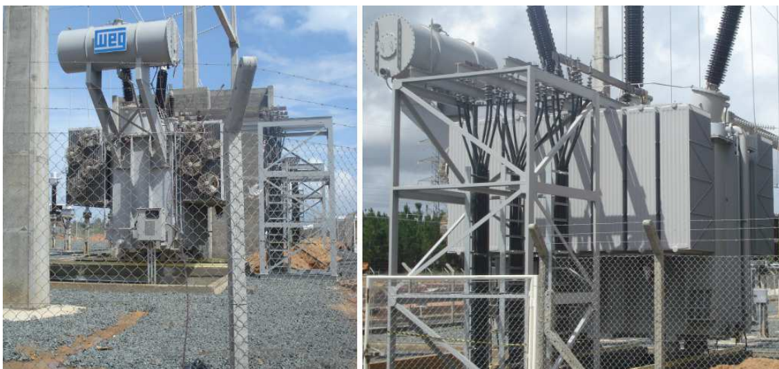
Figura 59 – Transformador elevador WEG.
