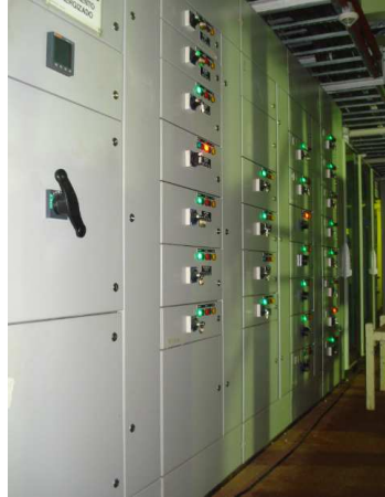
Figura 13 – Vista frontal do Painel CCM DAS 1.
