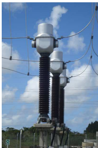
Figura 64 – Transformador de Corrente da subestação 230 kV.
