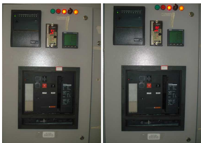
Figura 10 – Disjuntores de interligação de barramentos do CDC.
