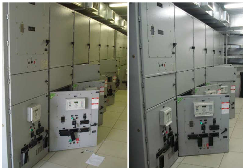
Figura 36 – Painéis EATON 13,8 kV.
