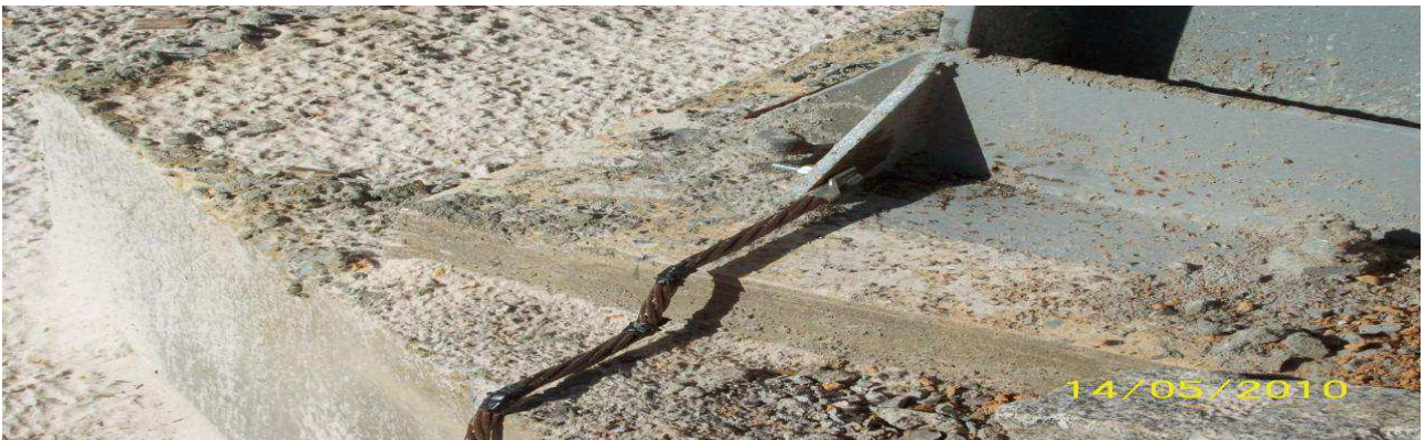
Figura 4. Aterramento da coluna metálica da casa de força.
