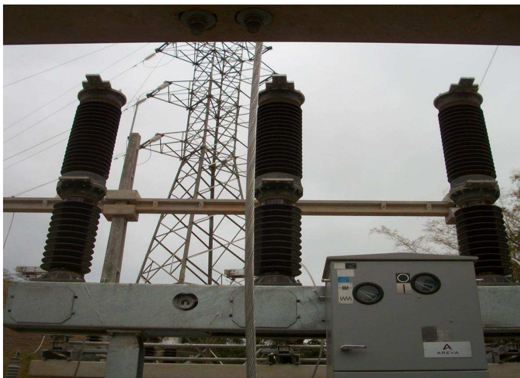
Figura 16. Disjuntor da UTE SJP.
