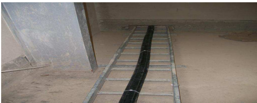
Figura 7. Encaminhamento para cabo de média tensão.
