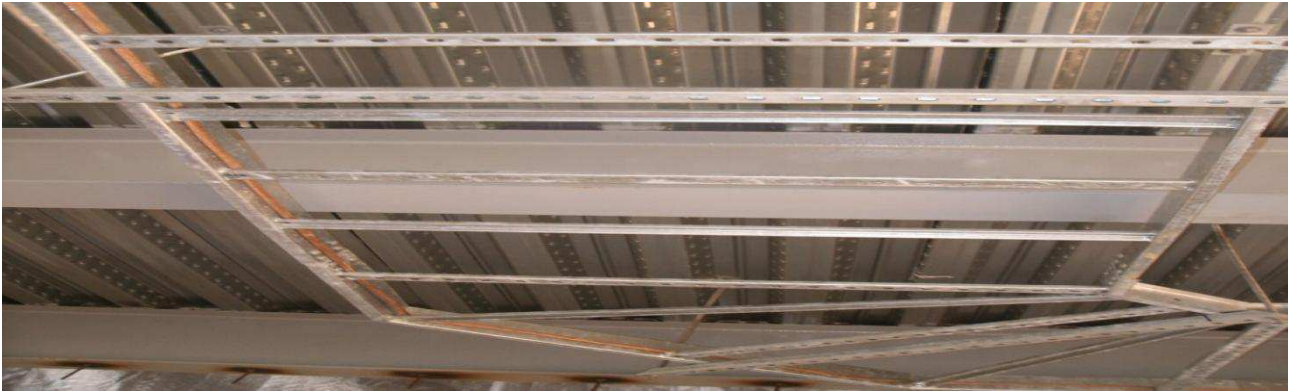
Figura 3. Aterramento do leito de baixa tensão.
