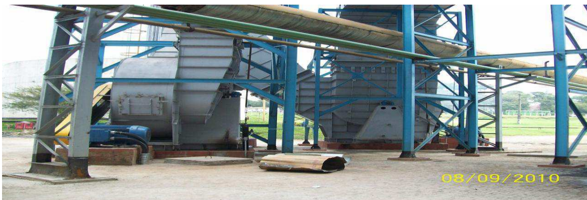
Figura 11. Exaustores das caldeiras.
