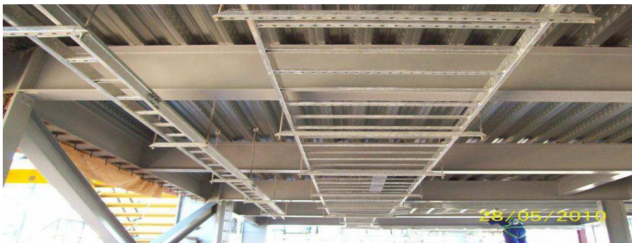
Figura 6. Encaminhamento de comando e baixa tensão.
