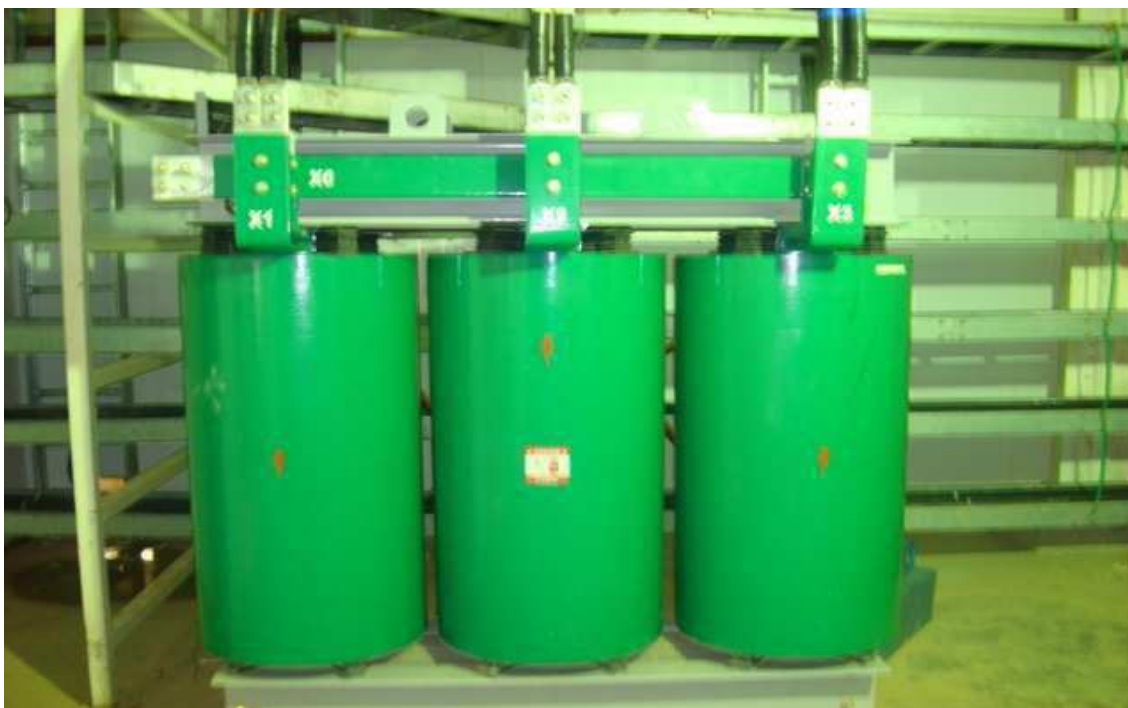
Figura 8. Transformador utilizado para serviços auxiliares.
