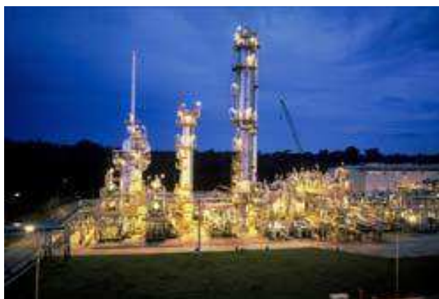
Figura 4 – UPGN (Unidade de Processamento de Gás Natural) Fonte: http://www.tpn.usp.br/petroleo/UPGN1.jpg
