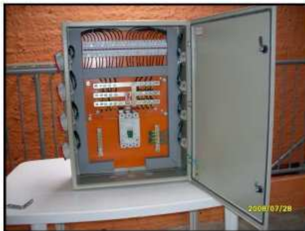
Figura 6 - Quadro de tomadas
