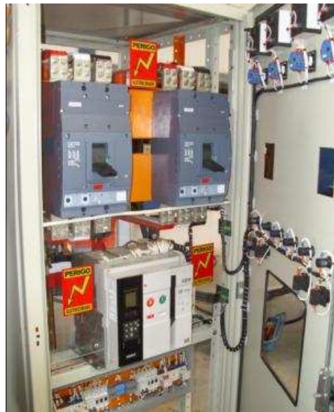
Figura 19 - Quadro para transferência de carga.
