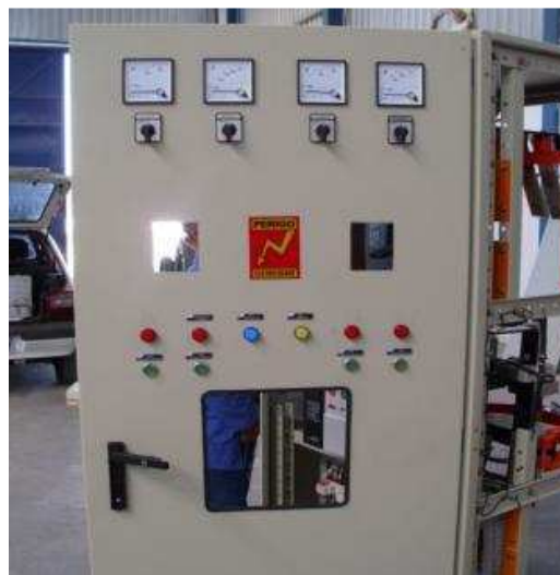
Figura 20 - Sinalização da transferência de carga
