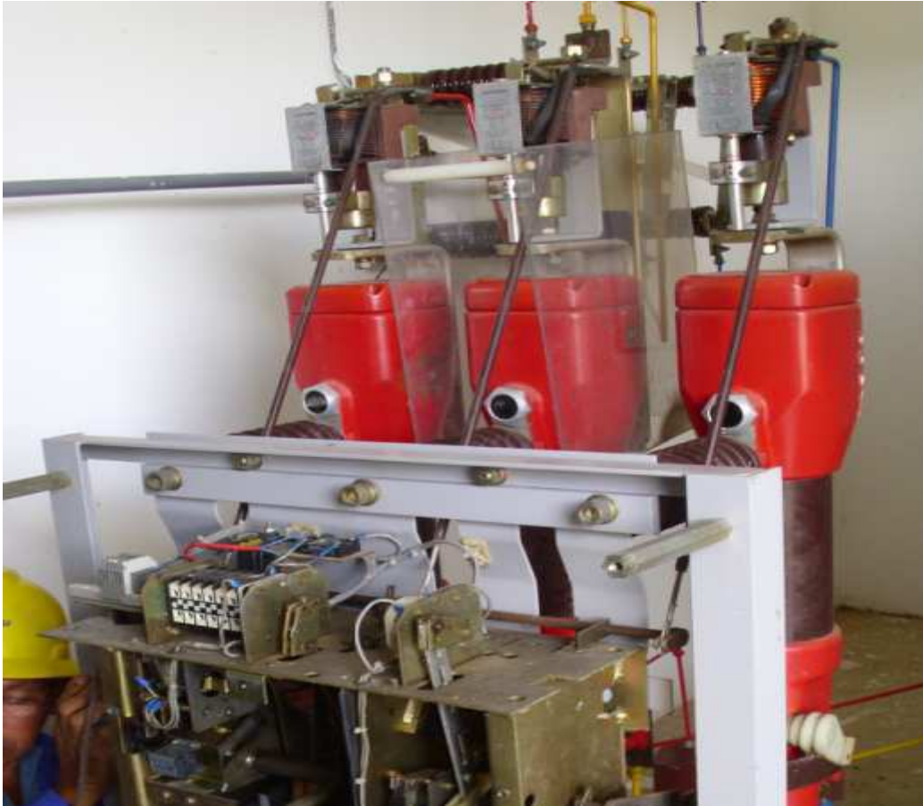
Figura 4 - Disjuntor 13.8kV, 15kA, AREVA.
