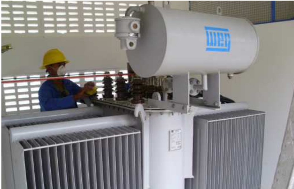
Figura 5 - Transformador WEG de 1000 kVA.
