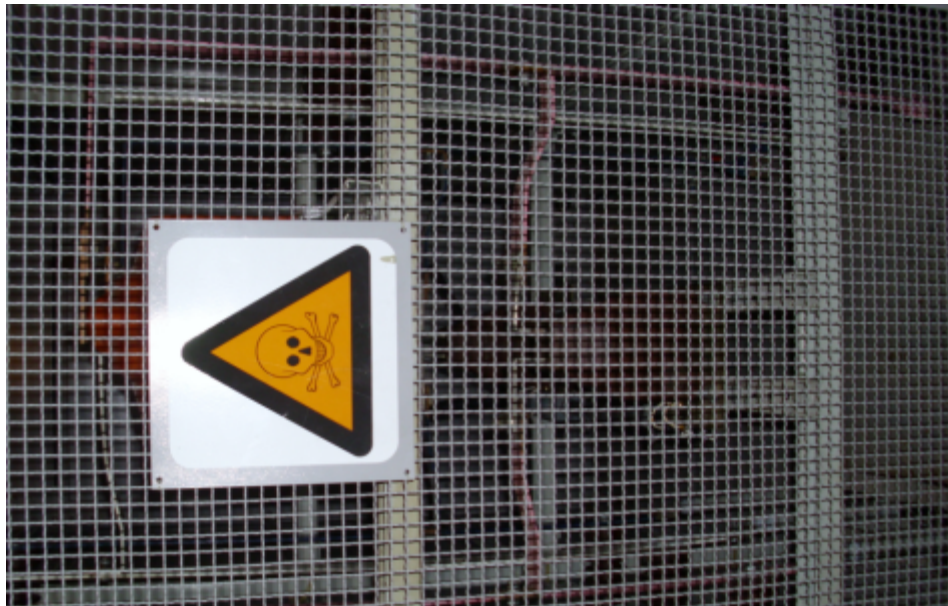
Figura 3 - Grade metálica com sistema de aterramento.
