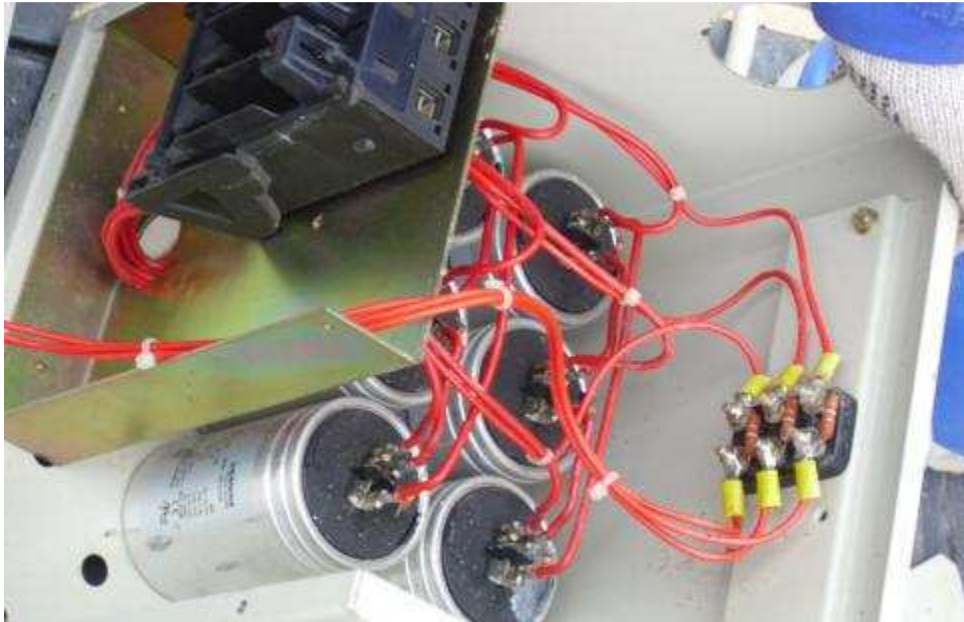
Figura 2 - Banco de Capacitor.
