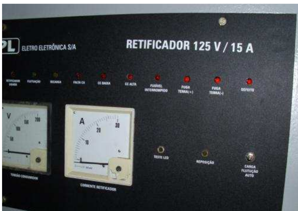
Figura 21 - Quadro para Transformação e retificação da tensão da Rede.
