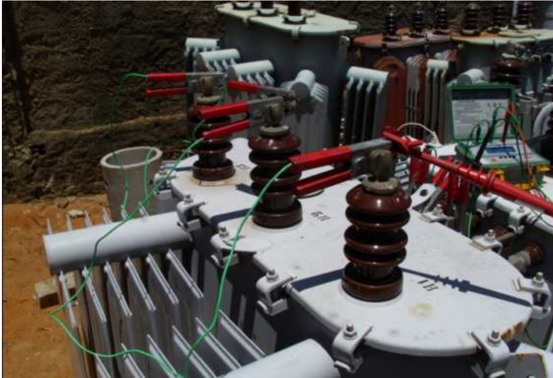
Figura 9 - Teste de Resistência de Isolamento de um Transformador.
