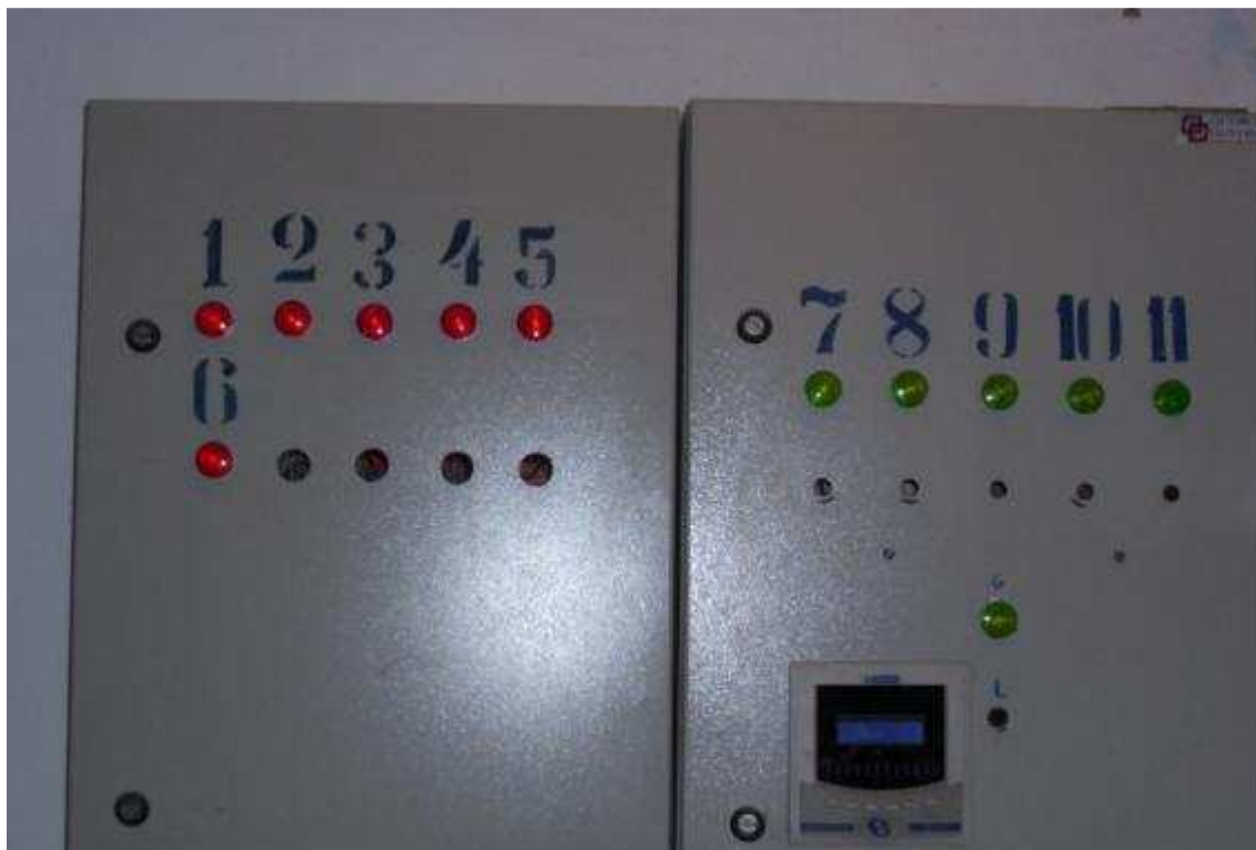
Figura 24 - Quadro automático para correção de fator de potência.
