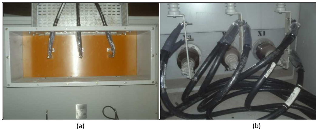
Figura 12. Terminações Contráteis (a) Transformador auxiliar e (b) Transformador Elevador. Fases R, S e T. UHE São José-RS.
