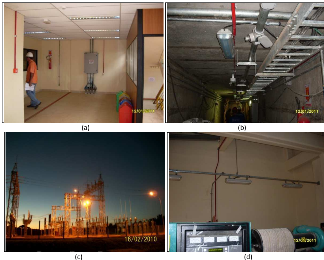
Figura 14. Iluminação (a) setor administrativo, (b) galeria da barragem, (c) subestação e (d) grupo gerador diesel.
