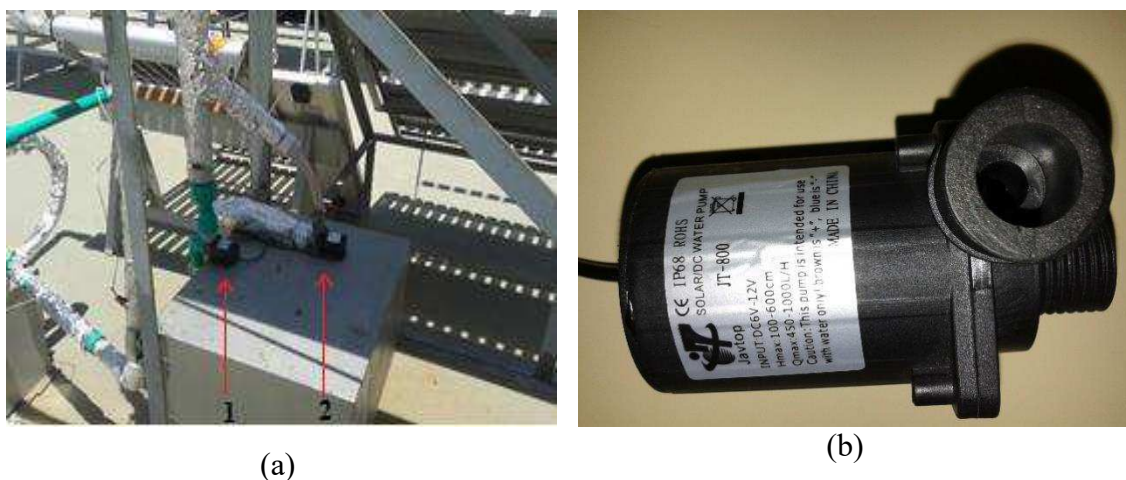
Figura 3.7 – Bombas centrífugas (a) e imagem detalhada da bomba centrífuga (b)
