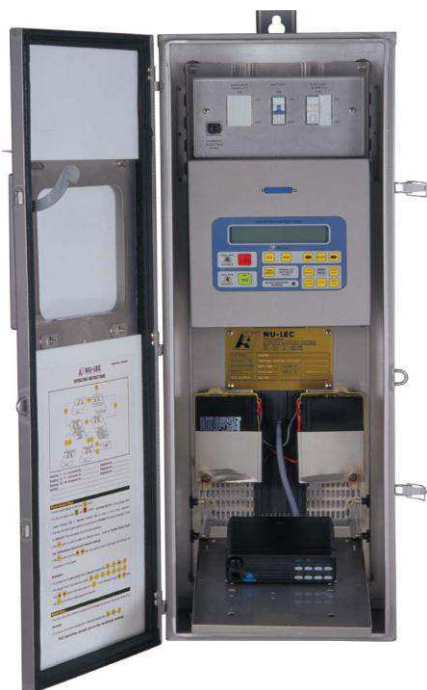
Figura 7: Cubículo de controle - Nulec
