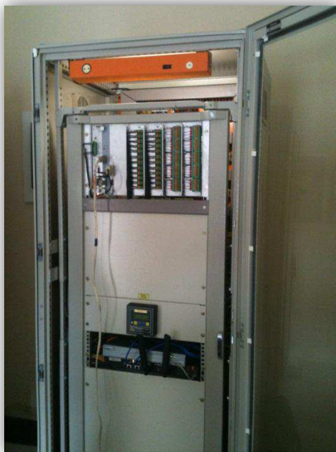
Figura 24: UTR da subestação de Mussuré, João Pessoa - PB.
