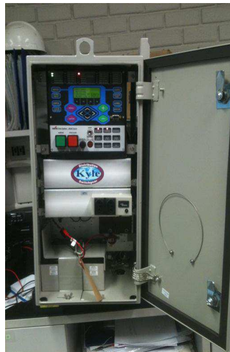
Figura 10: Cubículo de controle Cooper.
