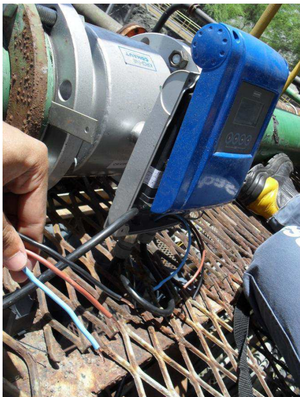
Figura 32 – Foto do medidor de vazão.
