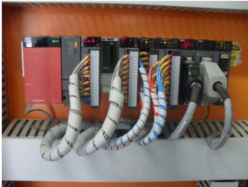
Figura 28 – Foto do rack com fonte, PLC e cartões Mitsubishi.
