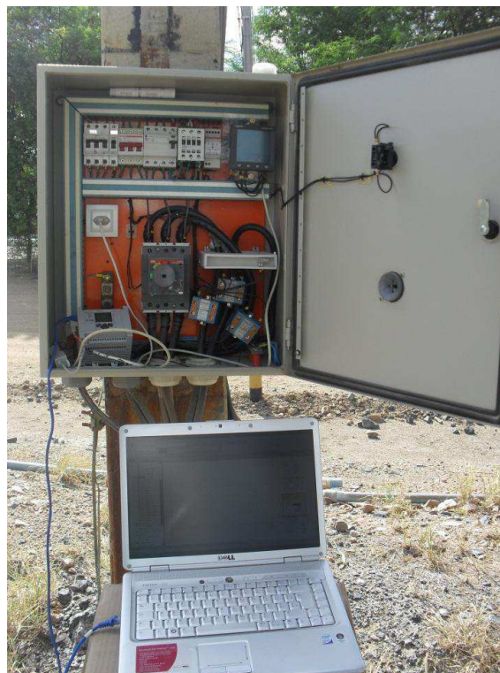
Figura 43 – Foto do sistema instalado e em fase de testes em campo.
