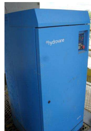
Figura 22 – Foto do Hydrovane HV15.
