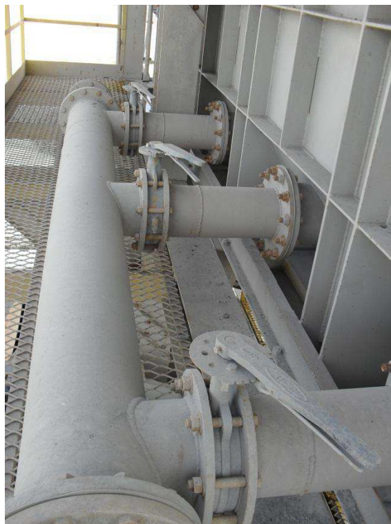
Figura 9 – Foto das válvulas borboleta que controlam a vazão de água.
