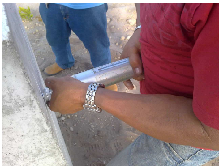
Figura 2.19: Realização de ensaio pós concretagem da fundação da estrutura 10/1 com esclerômetro, equipamento que mede a resistência à carga da peça concretada sem a necessidade de retirada de corpo de prova.
