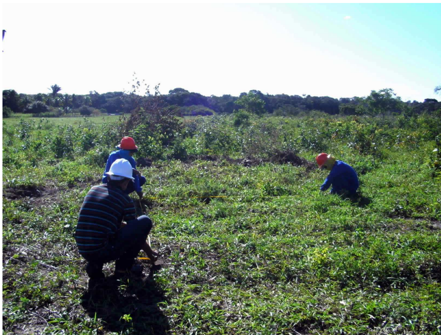
Figura 2.9: Locação de cavas da estrutura 13/4 da LT de 230 kV Goianinha - Mussuré II - Santa Rita II.
