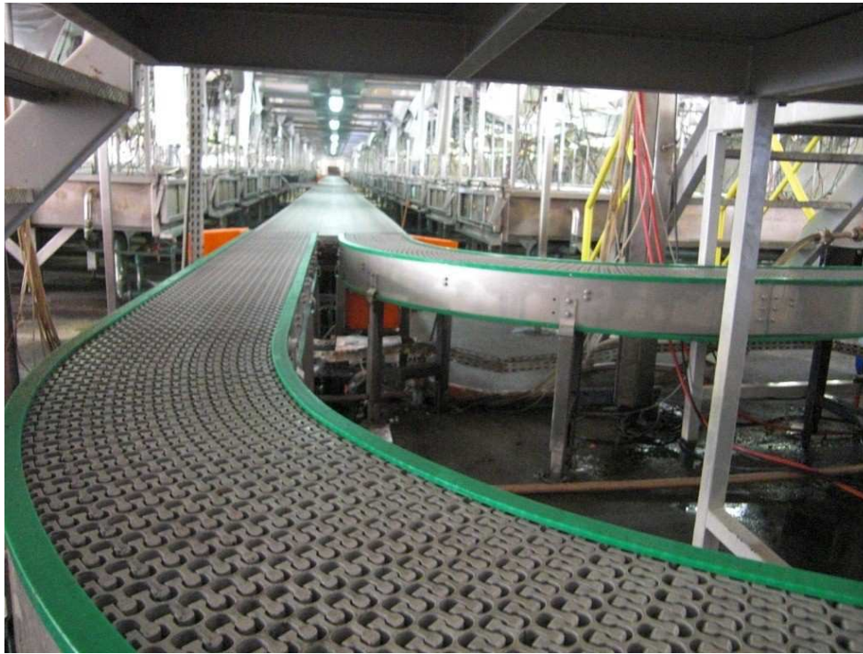
Figura 22- Sistema Transportador de Baterias.
