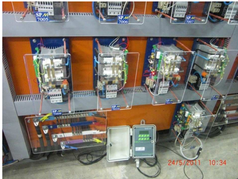
Figura 35-Analisador PowerNET P-600 instalado em um módulo SPM.
