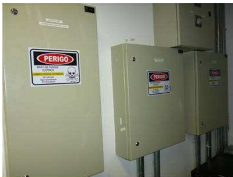
Figura 11: Quadros de força devidamente identificados
