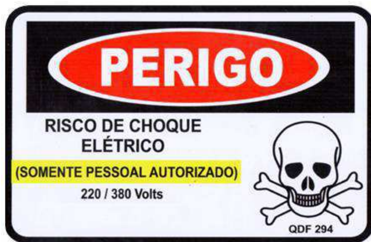
Figura 10: Placa de identificação dos quadros de força
