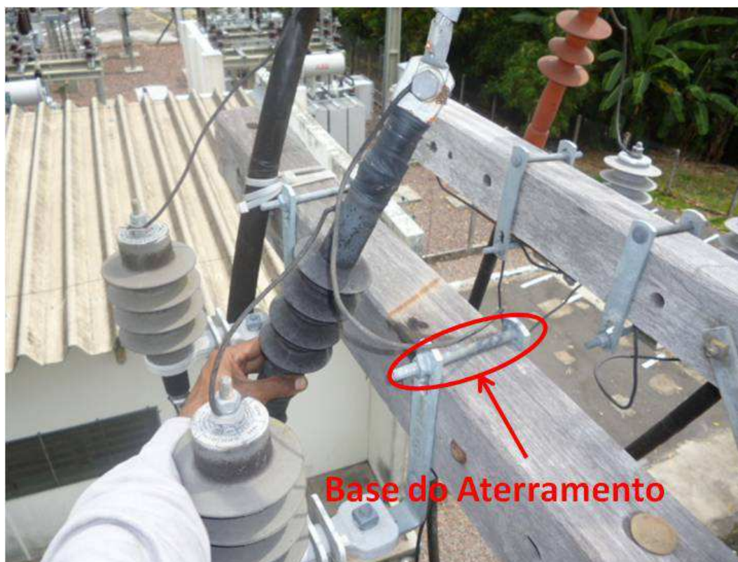
Figura 12: Falta fase-terra devido o rompimento da abraçadeira de sustentação
