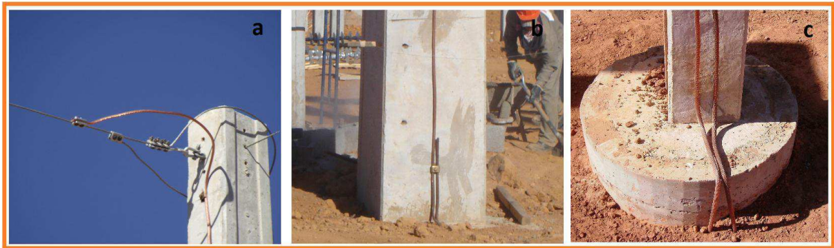
Figura 18 – Blindagem da Subestação: (a) cabo guarda e suas respectivas derivações (b) aterramento de pórtico (c) aterramento para equipamento
