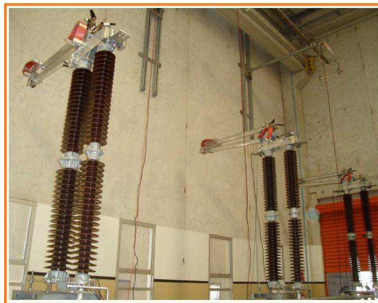
Figura 29 – Chave Seccionadora Semi-Pantográfica com Abertura Vertical
