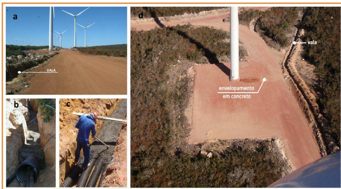
Figura 32 – Características da Rede de Distribuição: (a) valas ao longo do acesso às torres (b) e (c) envelopamento em concreto (d) envelopamento e rota alternativa para escavação de vala
