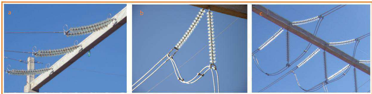
Figura 16 – Cadeias de Ancoragem dos Barramentos: (a) dupla (b) simples em derivação (c) simples passante
