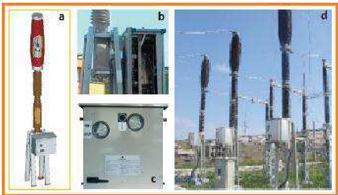
Figura 25 – Disjuntor: (a) um dos pólos (b) mecanismo de acionamento dos contatos do disjuntor (c) quadro de comado (d) unidade tripolar com módulo sincronizador
