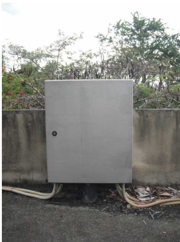
Figura 8. Caixa de Distribuição
