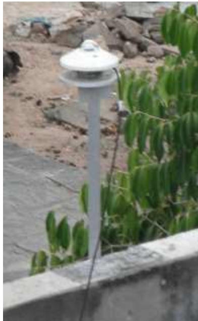
Figura 12. Sensor de Radiação Solar
