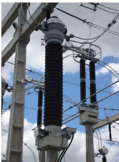
Figura 31: TC fabricado pela TRENCH Itália.
