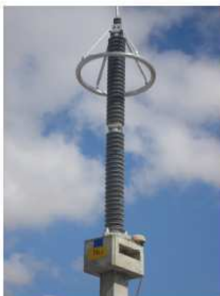
Figura 29: Para-raios 3EL2 da SE COTEMINAS.
