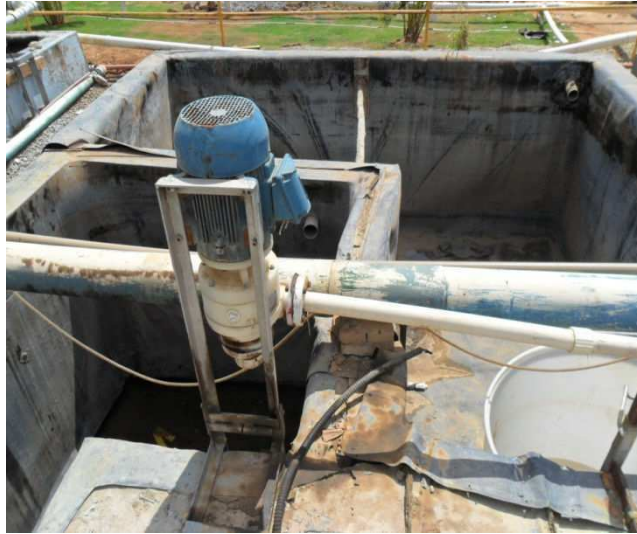
Figura 36. Tanque de armazenamento de água com problema.
