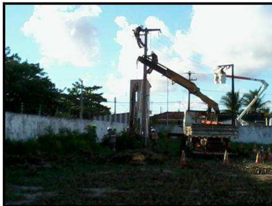
Figura 10 - Ruptura e tombamento do poste. Junho de 2012.
