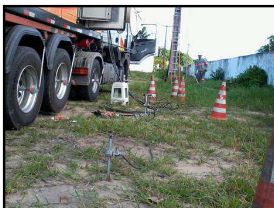
Figura 7 - Vista lateral do gerador e seus pontos de aterramento. Junho de 2012.
