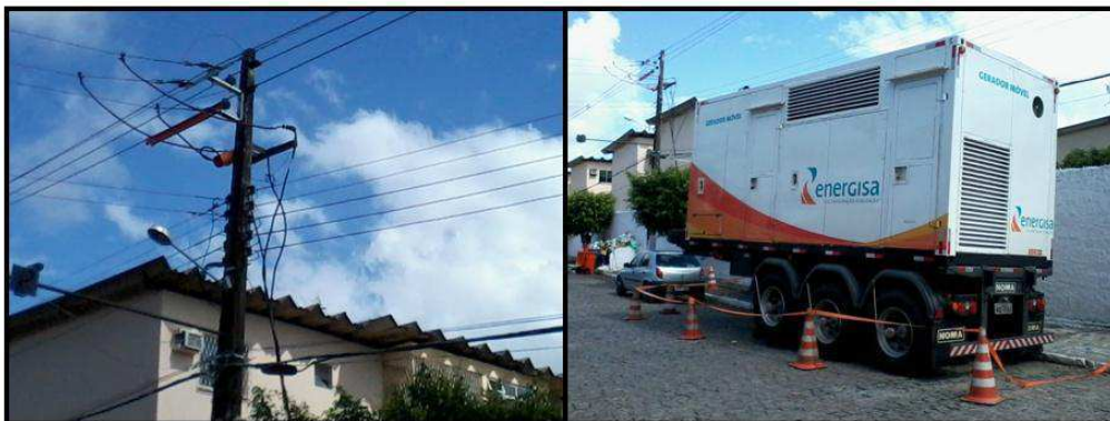
Figura 3 - Gerador em operação. Junho de 2012.
