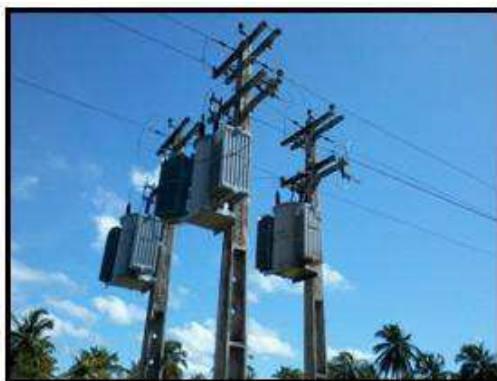
Figura 20 - Banco de reguladores de tensão para manutenção. Maio de 2012.
