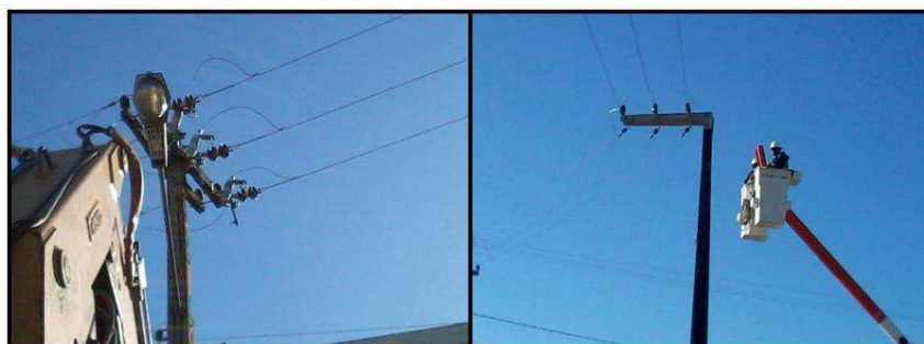
Figura 8 - Abertura das chaves para desenergização do trecho e a equipe de linha viva para abertura de circuito anterior. Junho de 2012.
