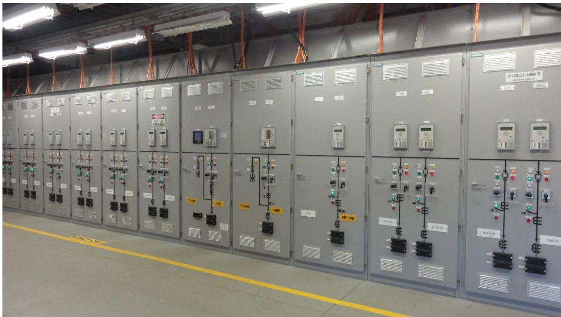
Figura 5. Vista dos painéis da subestação 112x.
