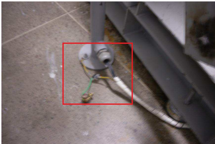
Figura 8 – Aterramento do Moinho
