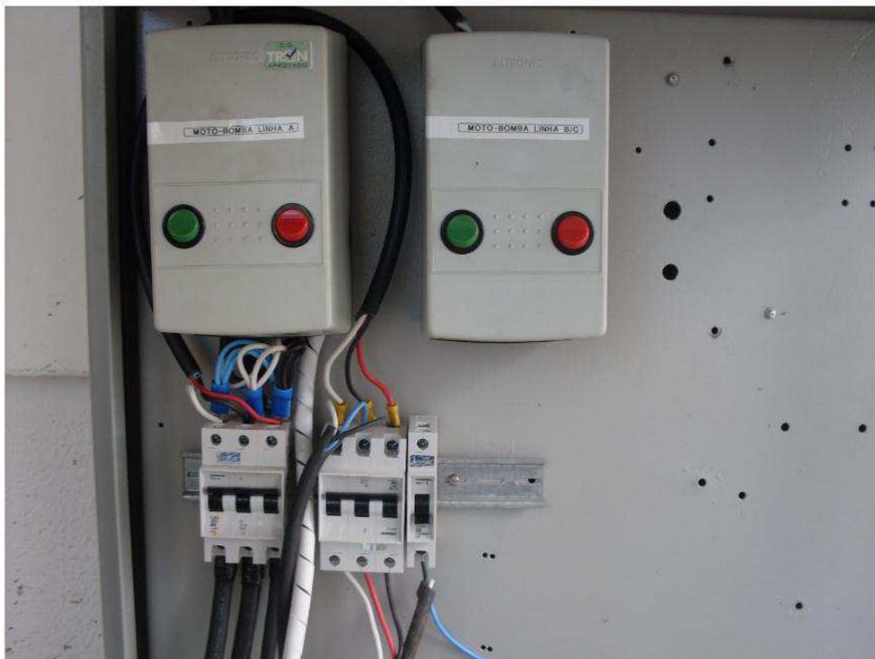
Figura 11 – Painel de Comando dos motores-Bomba
