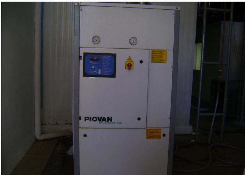
Figura 16- Chiller da PIOVAN
