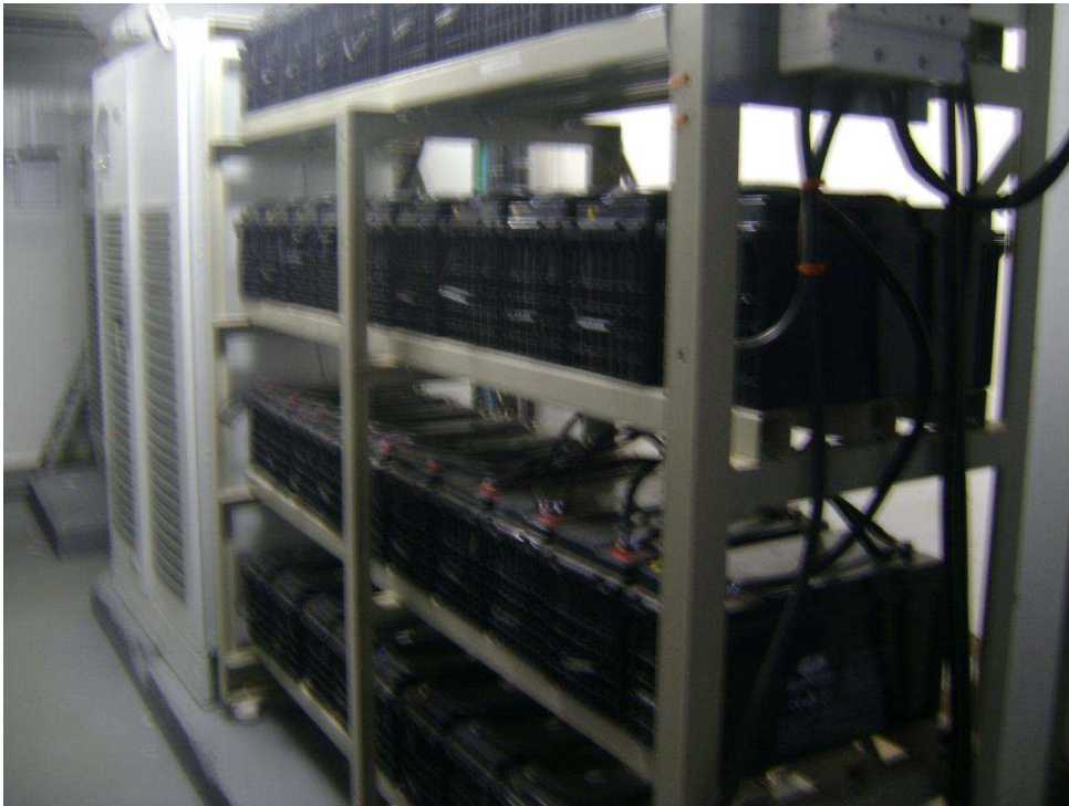
Figura 20 – No-break de 160KVA
