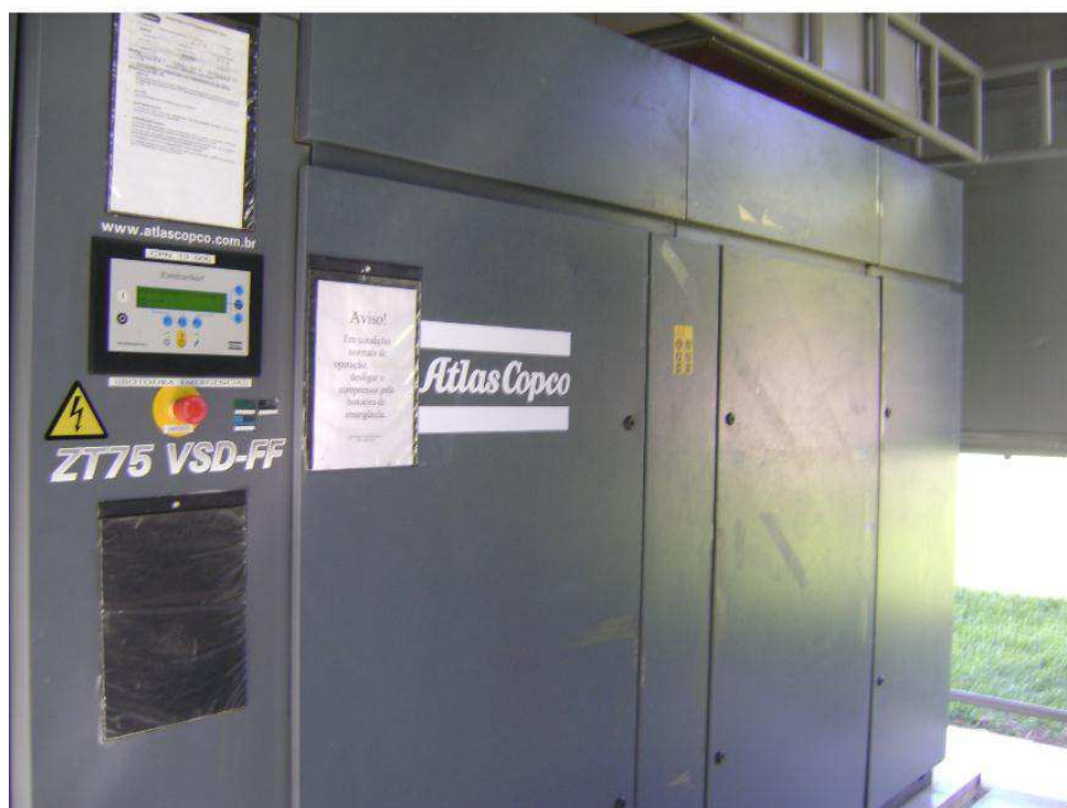
Figura 19- Compressor Atlas Copco
