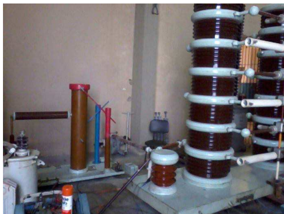
Figura 47. Gerador de Impulso de Tensão do LAT.
