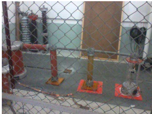
Figura 29. Arranjo experimental para medição da corrente de fuga.
