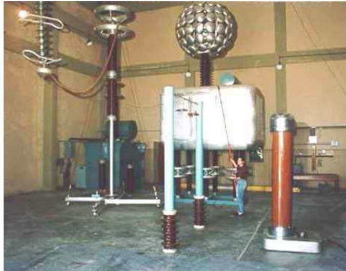
Figura 1. Salão de alta tensão (Grupo de Sistemas Elétricos, 2012).
