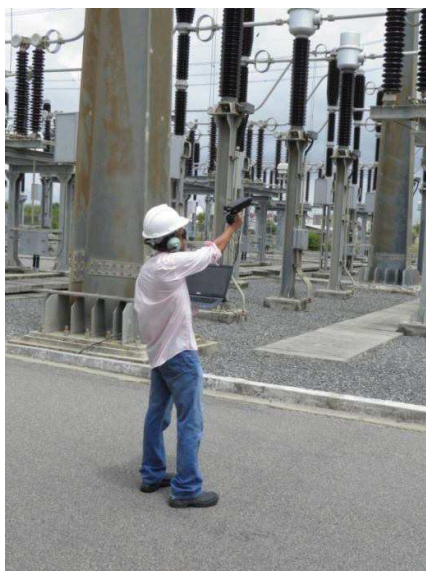
Figura 11. Medição de ruído ultrassônico em equipamentos da subestação da TermoPE.
