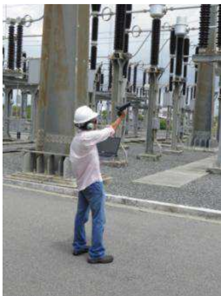
Figura 24 - Medição de ruído ultra-sônico e radio interferência em equipamentos da subestação da TERMOPE.
