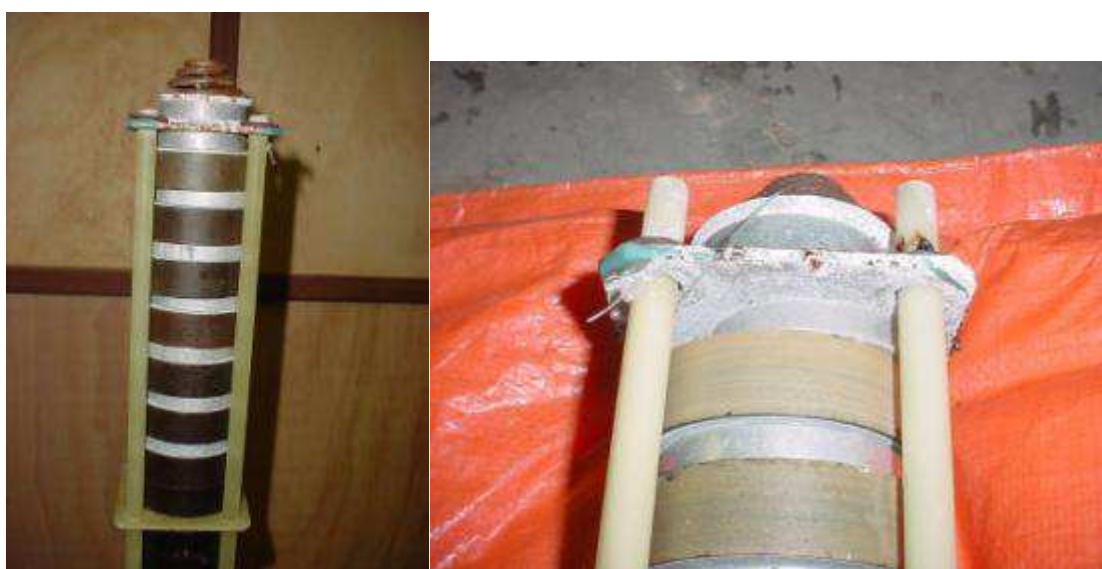
Figura 10 - Presença de sinais de degradação devido à penetração da umidade.
