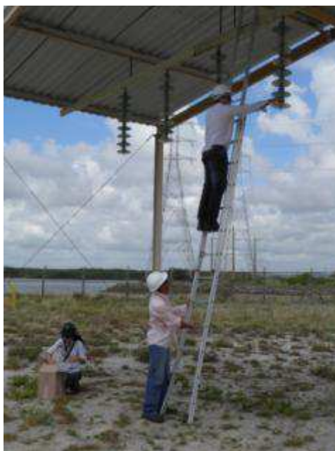
Figura 18 - Registro da retirada de duas unidades de isoladores de vidro tipo disco.
