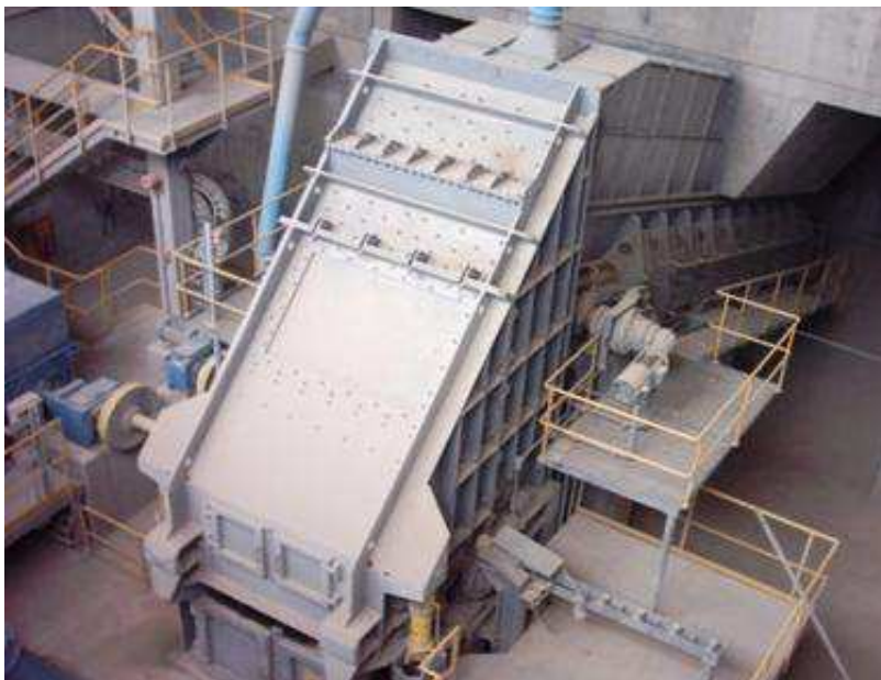
FONTE: CCB CIMPOR, 2006. FIGURA 2.2 – BRITADOR DE CALCÁRIO
