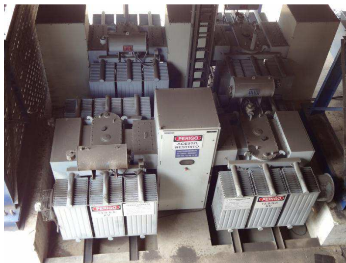
Figura 4.13 - Pátio com os transformadores elevadores.
