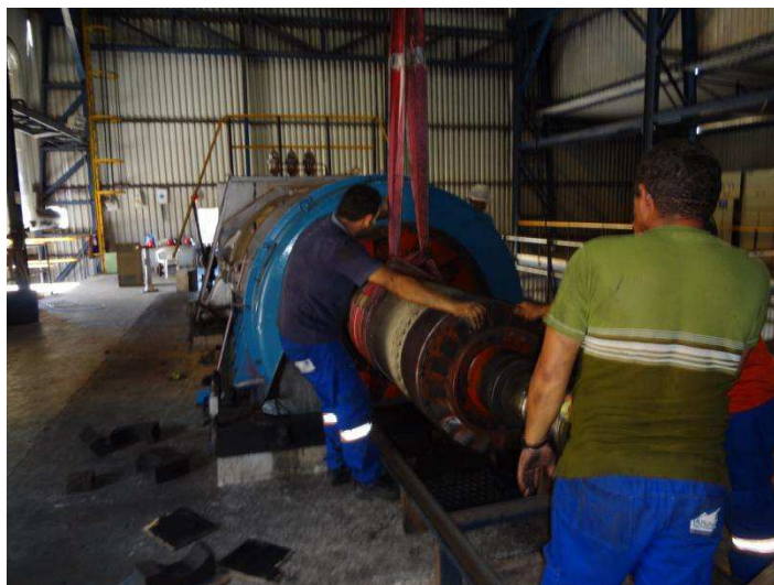
Figura 5.1 - Rotor sendo retirado para manutenção.
