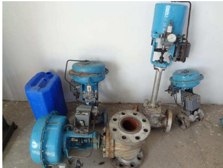
Figura 4.8 - Conjunto de válvulas eletro pneumática.
