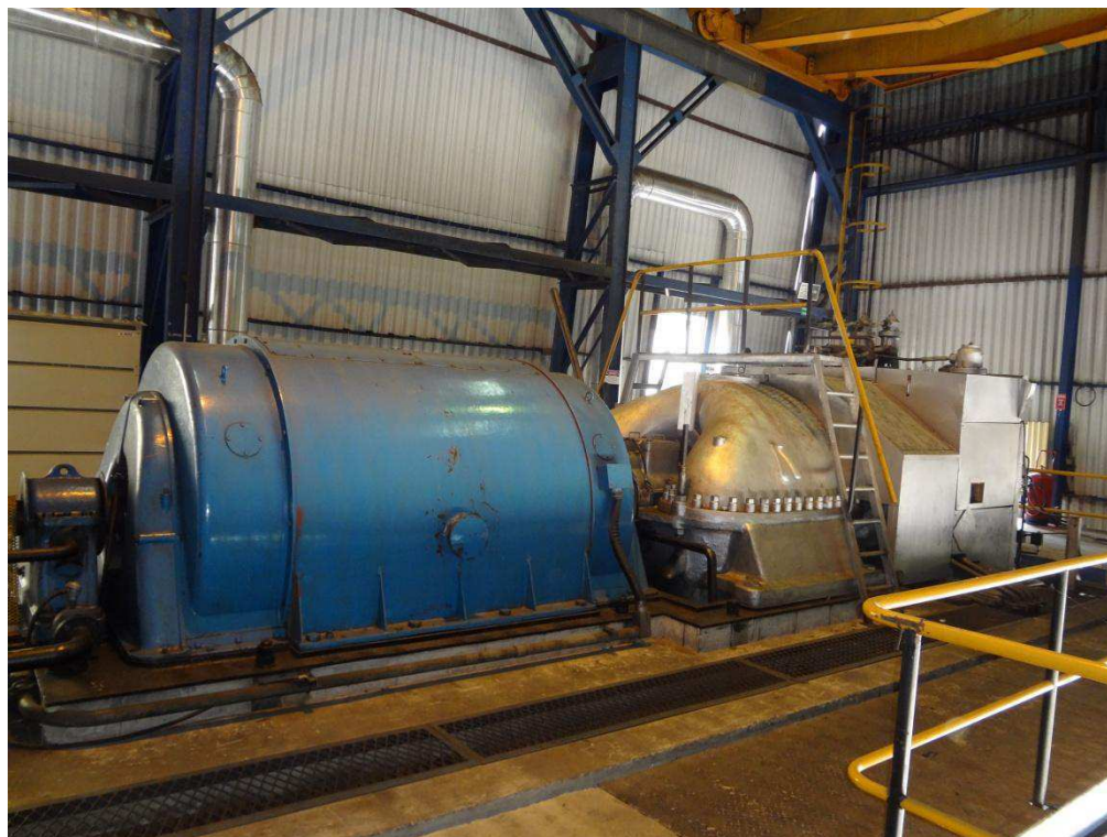
Figura 4.1 - Gerador principal acoplado à turbina tipo condensação.
