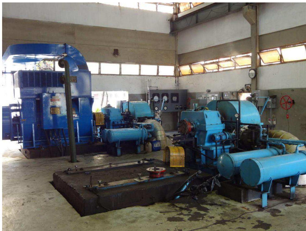
Figura 4.2 - Gerador auxiliar acoplado à turbina tipo contrapressão.
