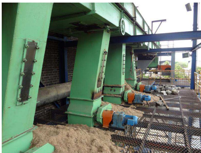
Figura 4.3 - Colunas de alimentação de bagaço da caldeira.
