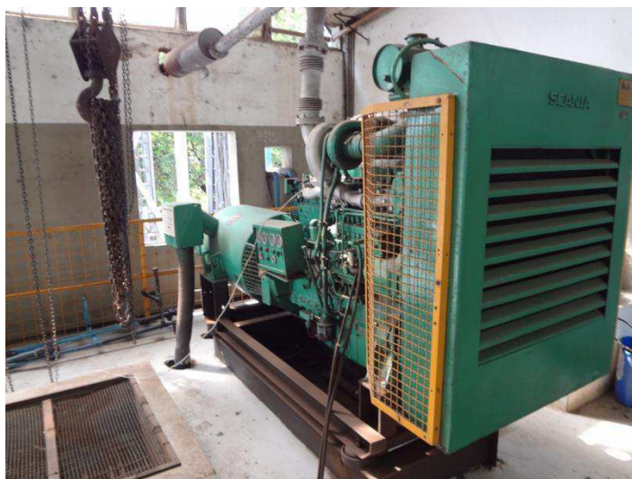
Figura 4.6 - Grupo moto-gerador de emergência.
