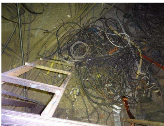
Figura 7.2 - Cabos elétricos acumulados em um ambiente confinado.
