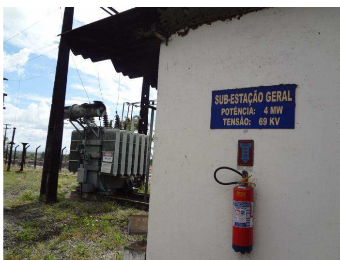
Figura 4.7 - Interior do pátio da subestação 69 kV.
