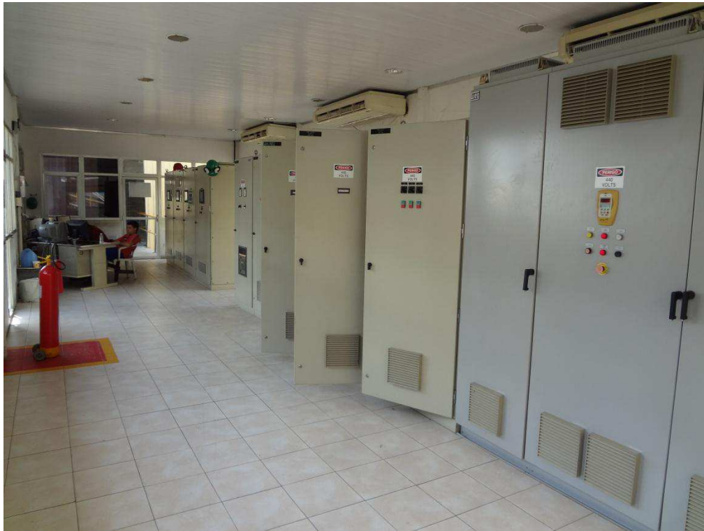
Figura 4.4 - Interior da sala de comandos.
