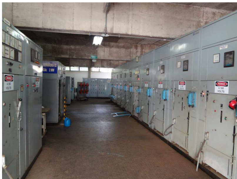
Figura 4.5 - Interior da casa de força 1.
