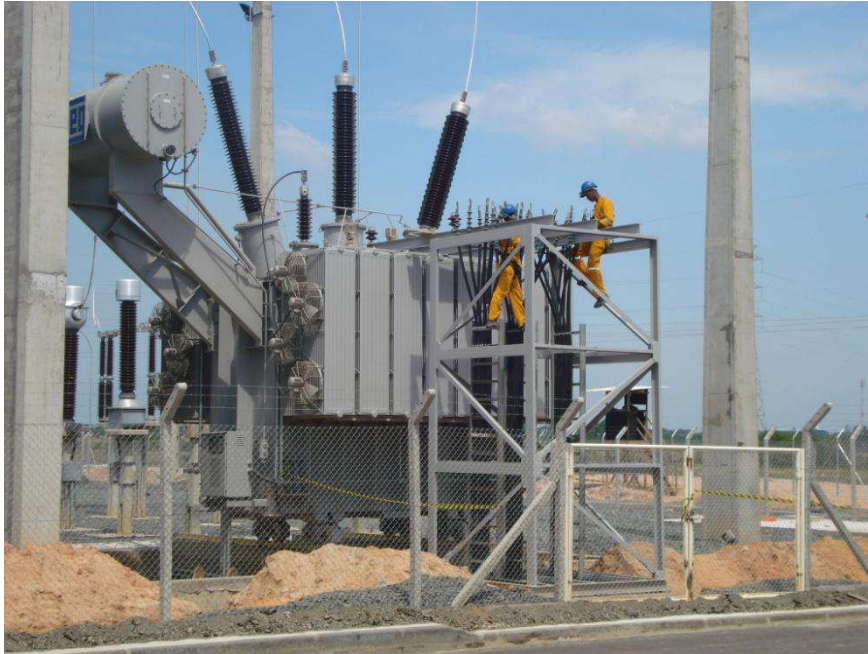
Figura 2.1 – Transformador Elevador 80/95 MVA
