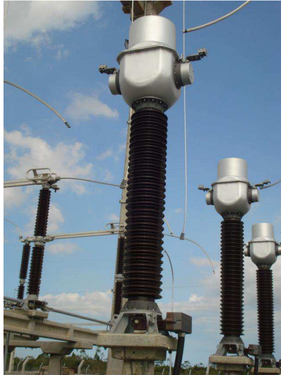
Figura 2.3 – Transformadores de Corrente
