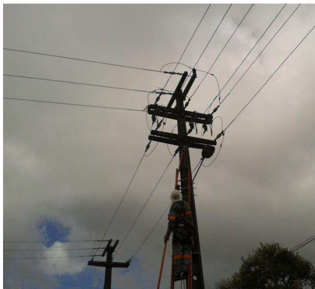
Figura 11. Verificação da ausência de tensão.
