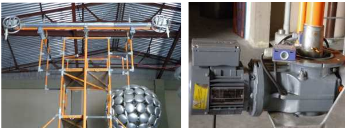
Figura 21 – Seccionador móvel com as pontas de provas - motor para abertura e fechamento da chave.
