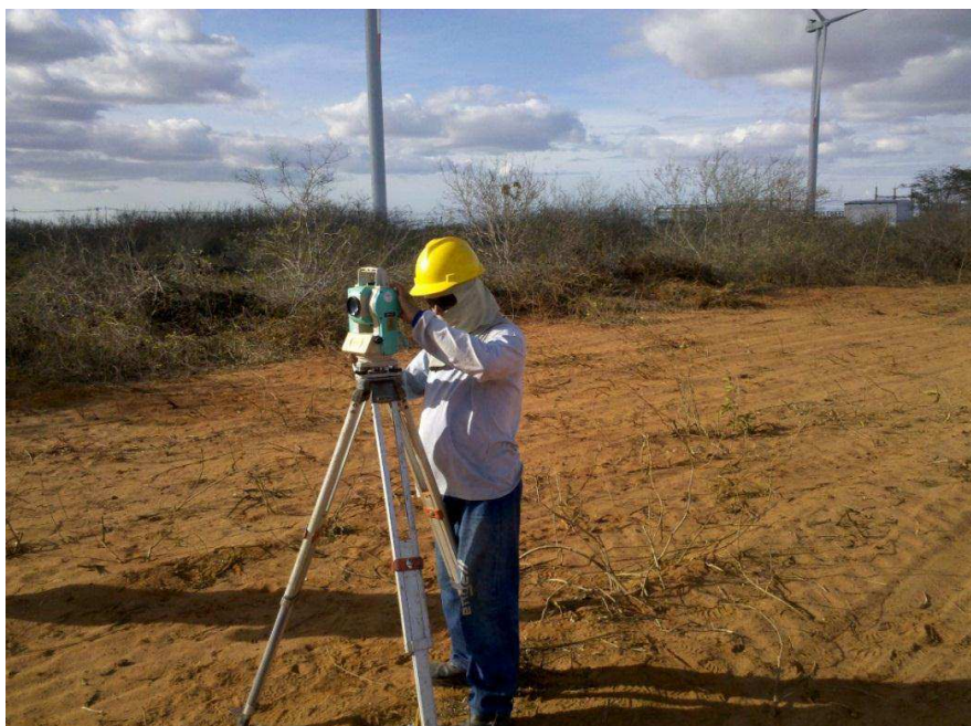
Figura 6. Conferência Topográfica - Implantação de Piquetes de Estruturas de Base/ Conferência de Alinhamento.
