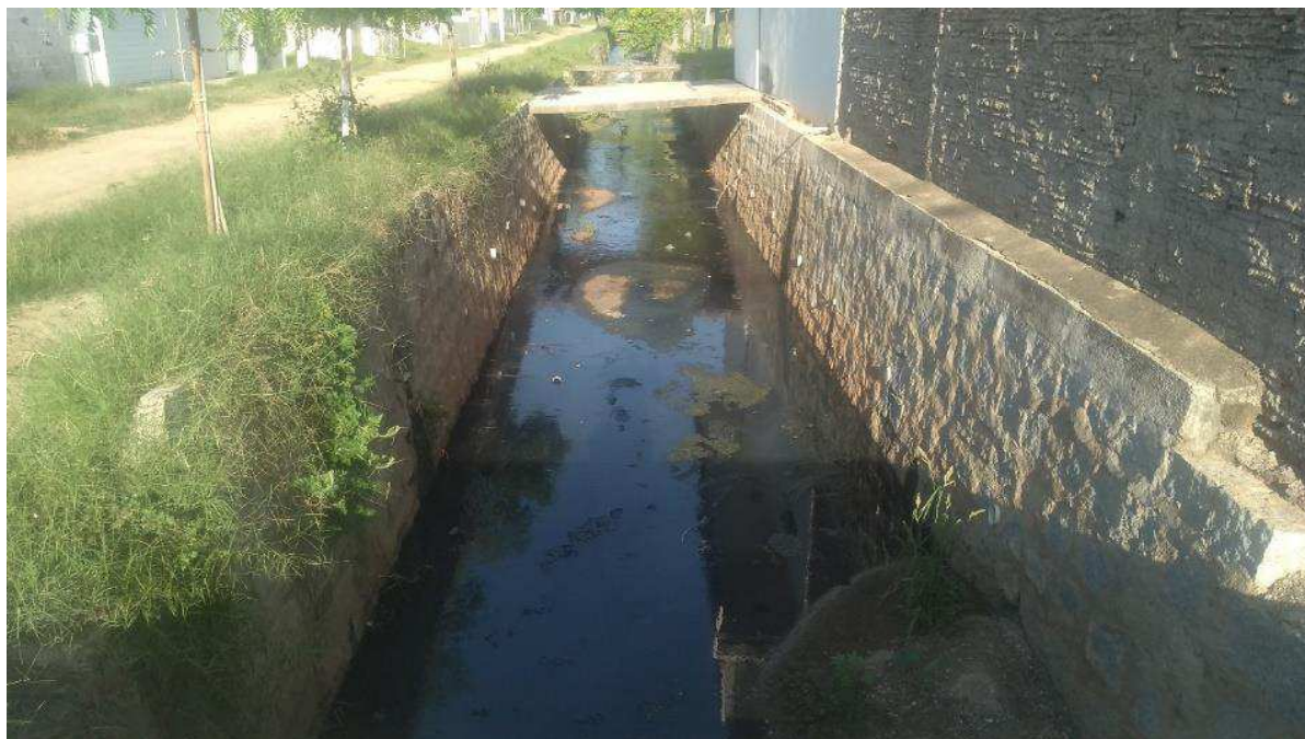
Figura 4 - Esgoto em Canal de Drenagem
