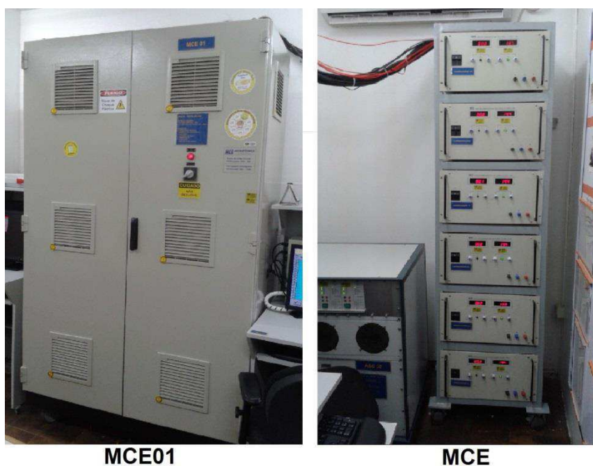
Figura 32 Equipamentos para realização dos teste de Consumod e Água e Aceitação de Carga
