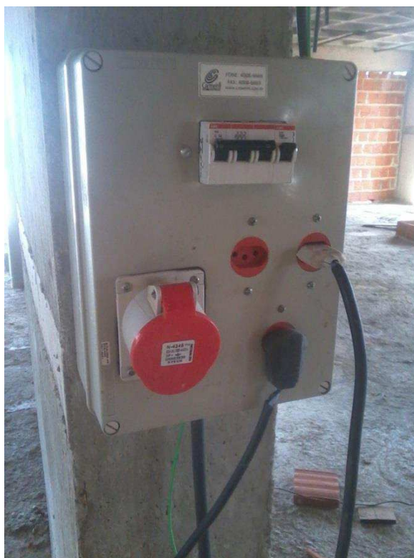
Figura 24. Quadro de tomadas.
